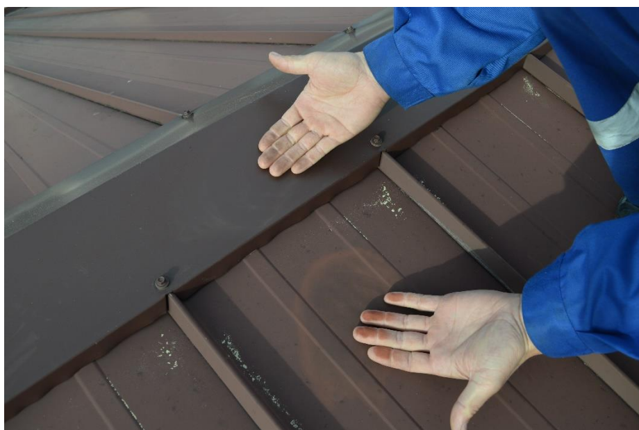
Obr. č.: 3.4.4.2.2 Nedostatočná ochrana pred UV žiarením. Z fotografie je evidentné, že na výrobu strešnej krytiny a hrebenáča boli použité materiály s rozdielnou odolnosťou proti UV žiareniu.
