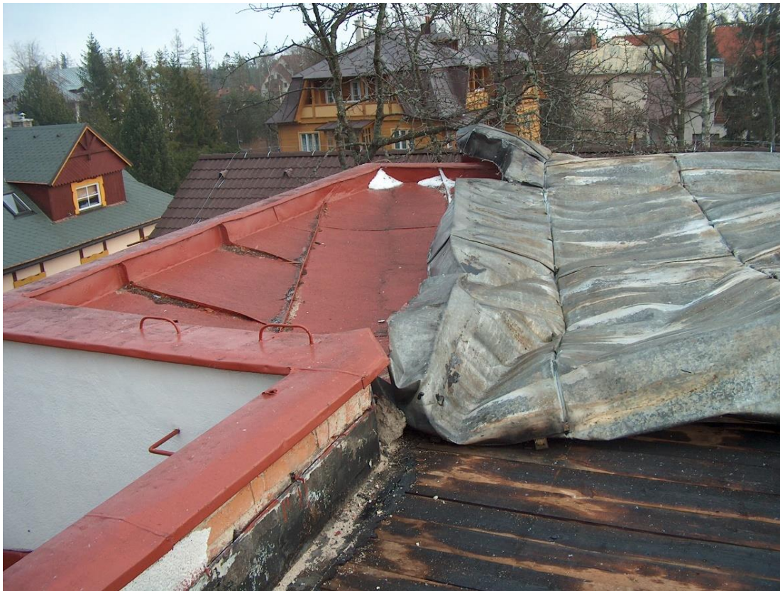
Stav ocelevej strešnej krytiny po päťdesiatich rokoch.
