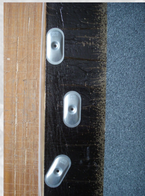
nepřípustné umístění kotevních prvků
