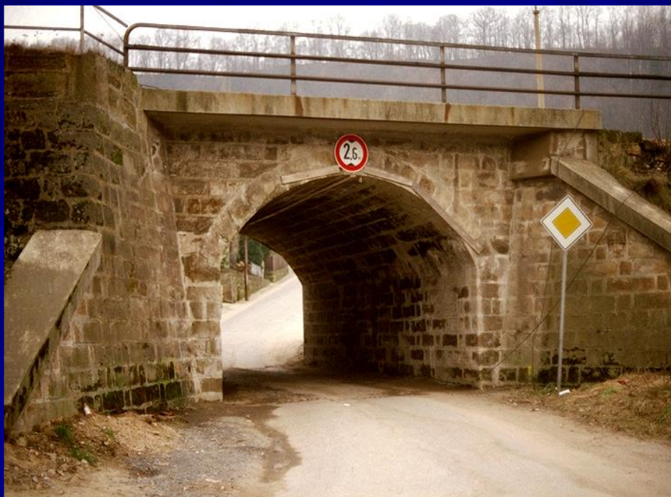
Stavební objekt z pískovce silně poškozený vlhkostí
