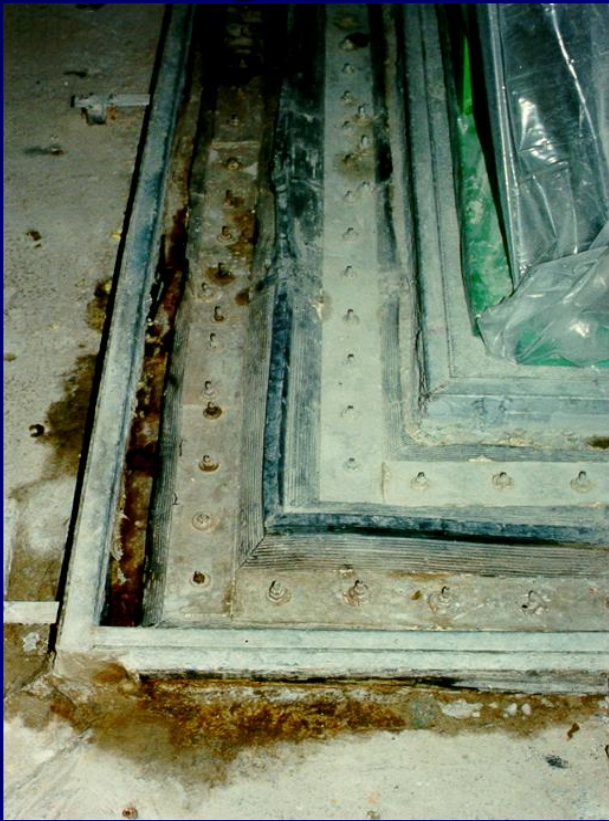
Netěsná dilatační spára
