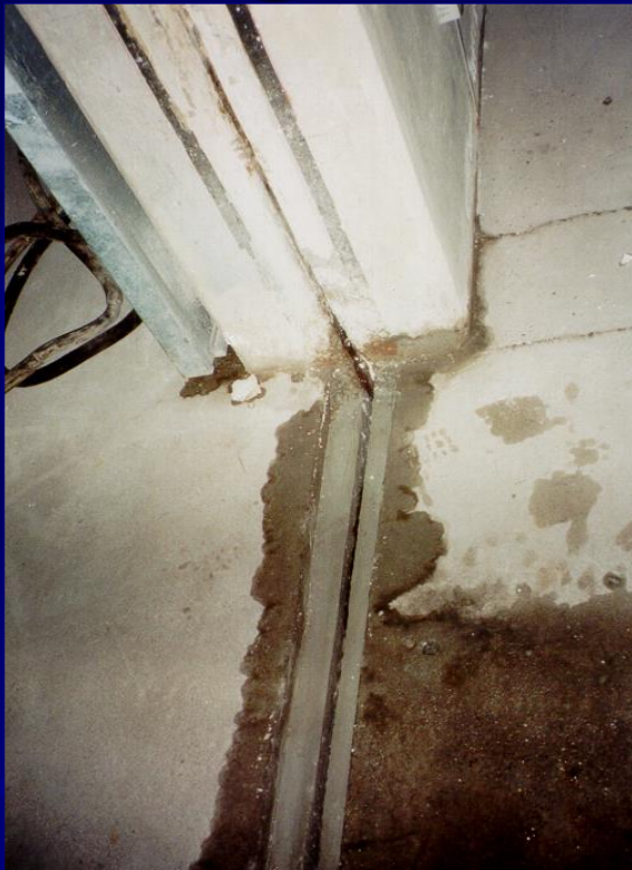
Netěsná dilatační spára podzemních garáží
