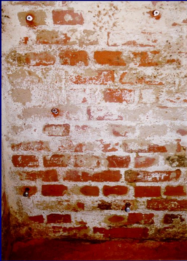
Vlhká zděná podzemní stěna
