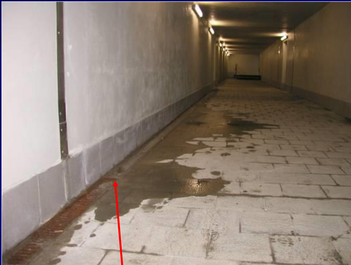
Netěsnosti v pracovních a dilatačních spárách
