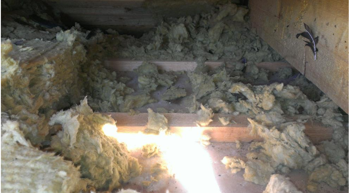
sešlapaná, rozcupovaná a vytahaná tepelná izolace
