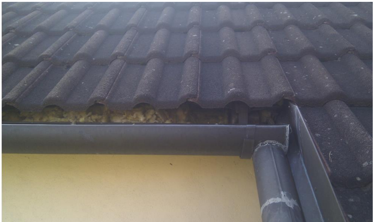
rozcupovaná tepelná izolace tam kde nemá být
