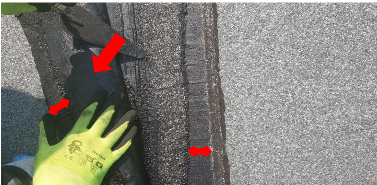
Obr. č. 1 – nedostatečná šířka svaru asfaltových hydroizolačních materiálů
