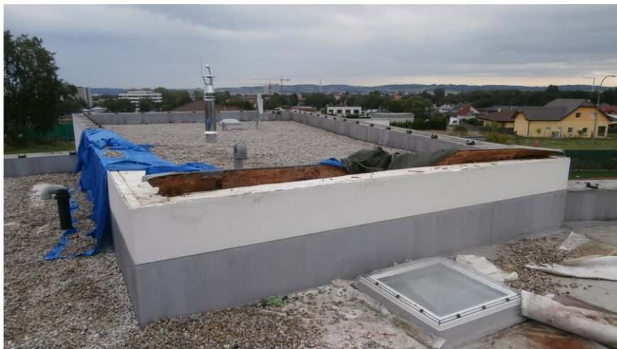
Obr. 1 - Větrems poškozená atika
