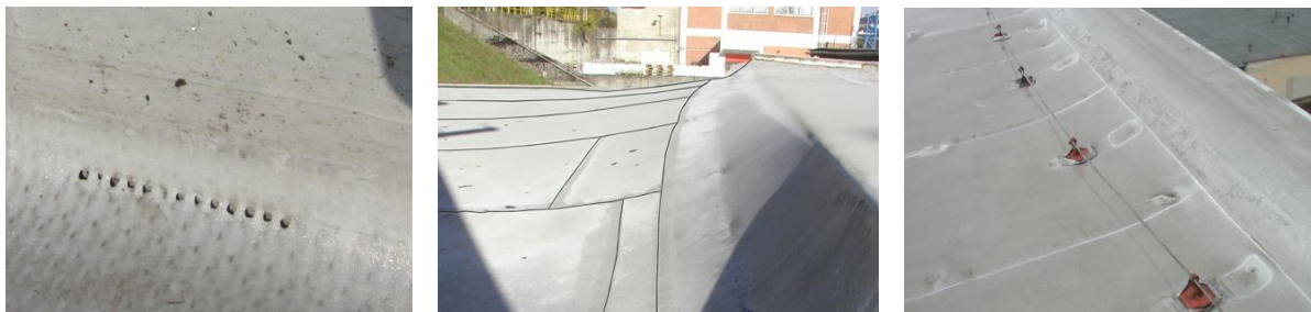
Obr. 10: Díry ve fólii po odtržení fólie od patečního L-profilu a odstrašující případ vzniku „trampolíny“
