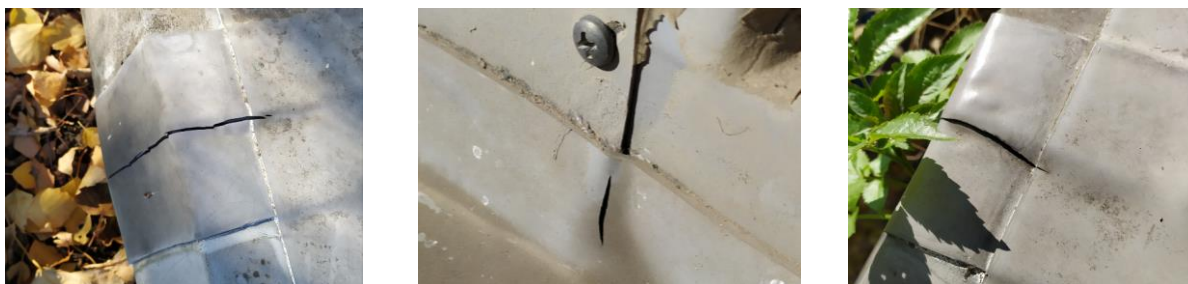
Obr. 4: Chybně provedené dilatační spoje – praskání fólie
