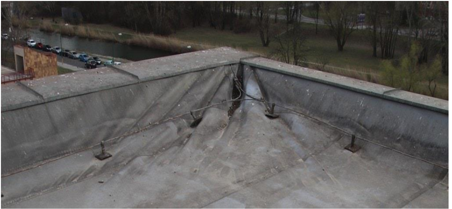
„opomenutí“ kotvení přechodu hydroizolace střešního pláště z plochy na atiku
