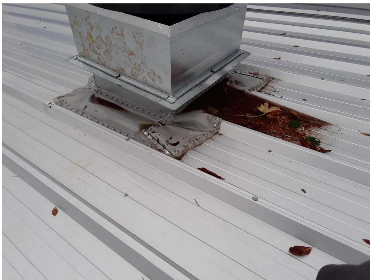
kotvení manžety (realizátor odmítl uznat reklamaci)
