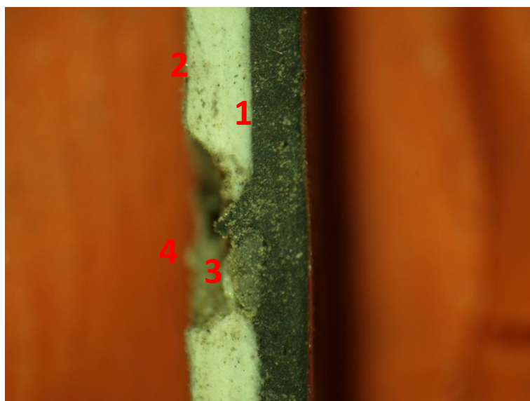
Obr. č. 92 – Mikrofotografie porušené vrstvy hydroizolace
