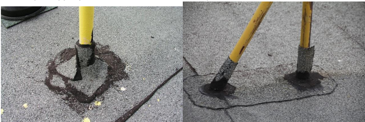
Obr. č. 234 – Nesystémové řešení tyčového prostupu
