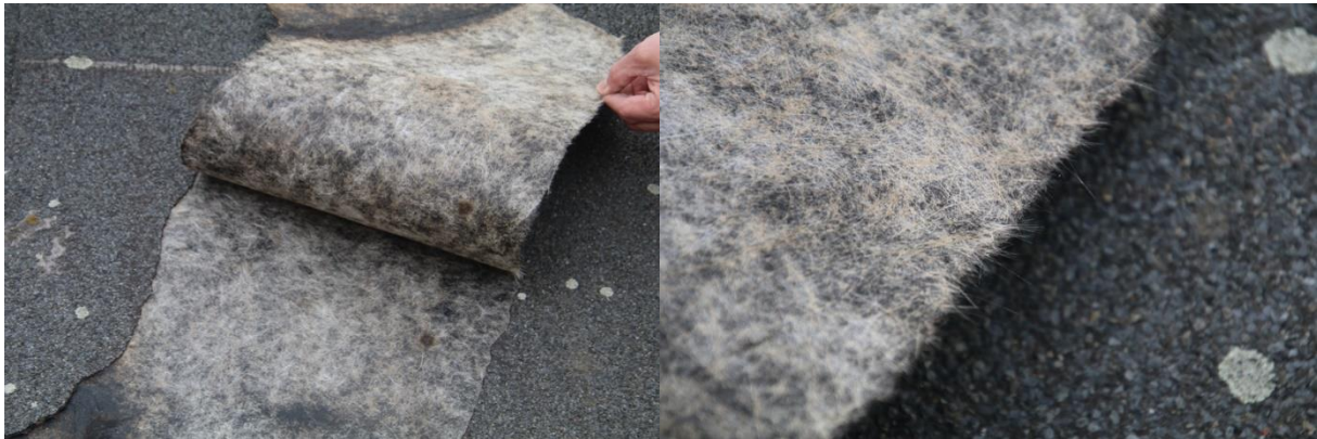
Obr. č. 182 – Delaminovaný asfaltový hydroizolační materiál s absencí penetračního asfaltu
