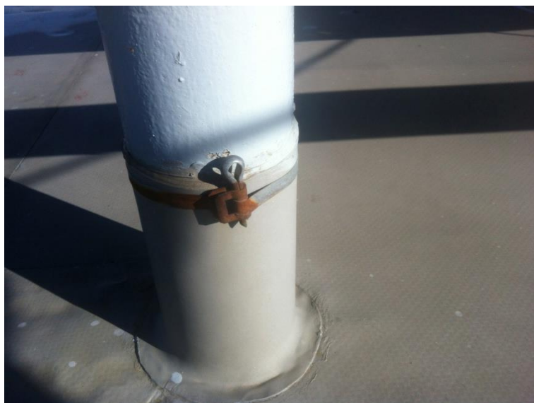
Obr. č. 149 – Sevření hydroizolace vytažené na kruhové potrubí pomocí rezavějící pásky
