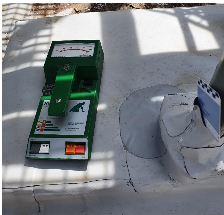
Obr. č. 164 – Velmi složitý detail, jehož nefunkčnost byla prověřena impedanční defektoskopií
