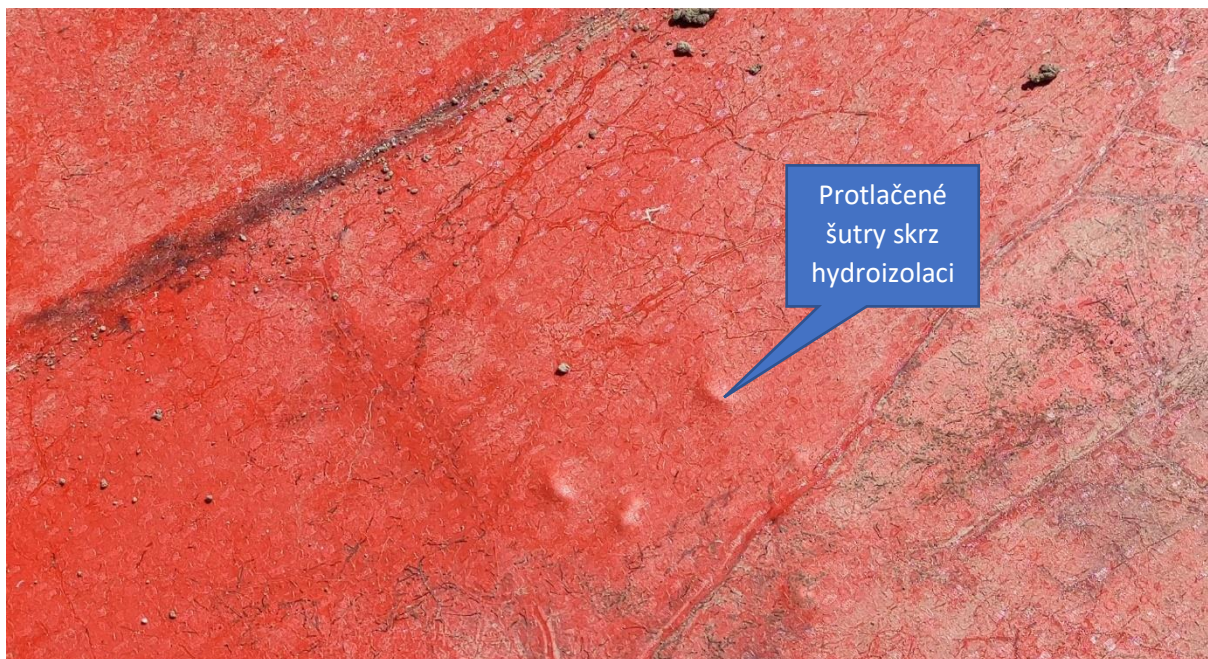
Obr. č. 54 – Protlačené šutry v hydroizolaci
