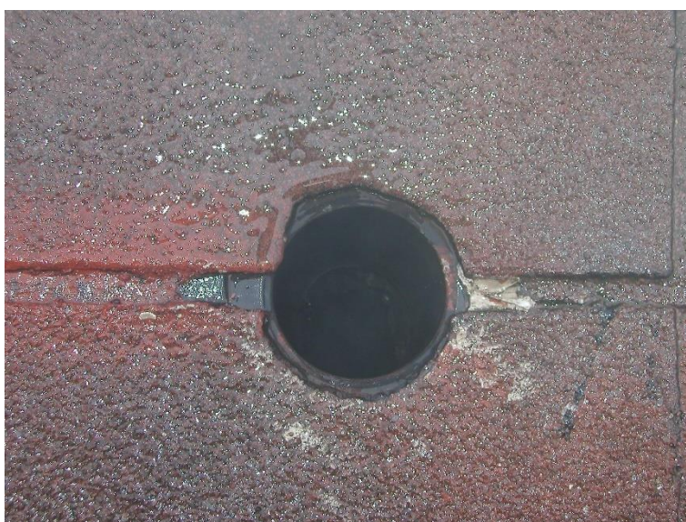
Obr. č. 247 – Při sanaci došlo k tomu, že se hydroizolační materiály nepotkaly tak, jak měly
