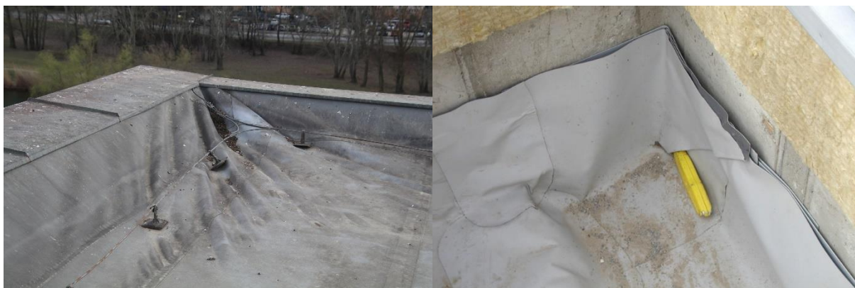
Obr. č. 138 – Deformace fóliového hydroizolačního povlaku v koutě při absenci korektního řešení ukončení na svislé konstrukci
