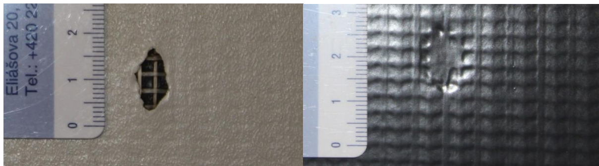
Obr. č. 91 – Detail poruchy hydroizolačního materiálu, kdy chybí jeho vrchní část
