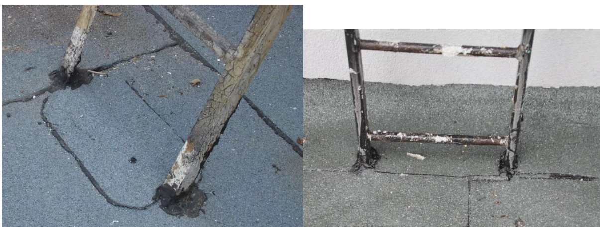
Obr. č. 248 – Prostup úhelníku, resp. stojky žebříku, který není řádně opracován
