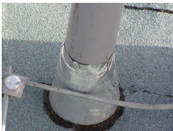
Obr. č. 230 – Detail ukončení klempířského prvku na prostupujícím tělese pomocí asfaltové samolepky, která (jak patrně) se již odděluje od podkladu
