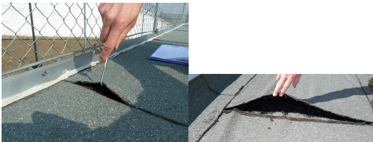
Obr. č. 208 – Řádně nesvařený hydroizolační povlak odhalila detekce kontrolní jehlou
