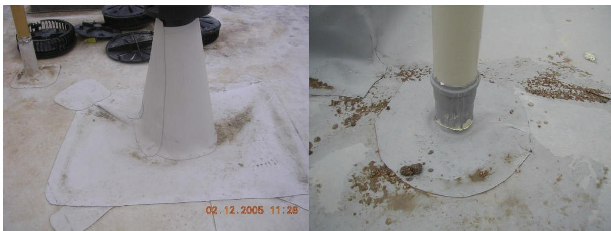
Obr. č. 147 – K prostupující kanalizační trubce je na tupo přivařená (spíše jen přibodovaná) manžeta. Na svistou část není vytažené nic, takže tento detail není vodotěsný.
