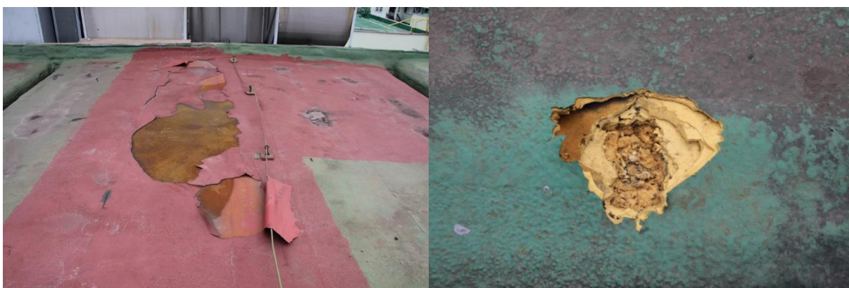
Obr. č. 70 – Destrukce vrchní fólie, resp. destrukce pěnového polyuretanu datlem
