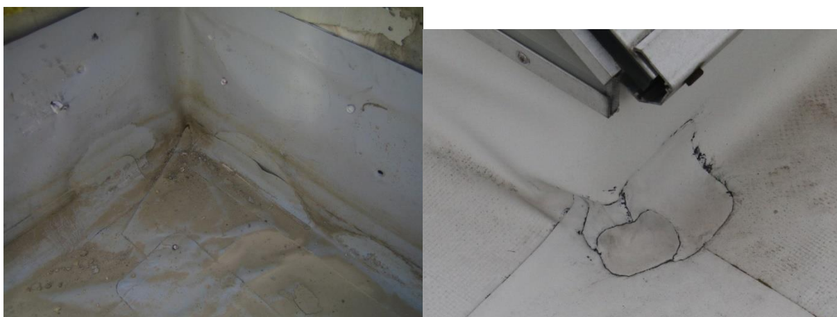
Obr. č. 139 – Chybné provedení hydroizolačního povlaku v koutě
