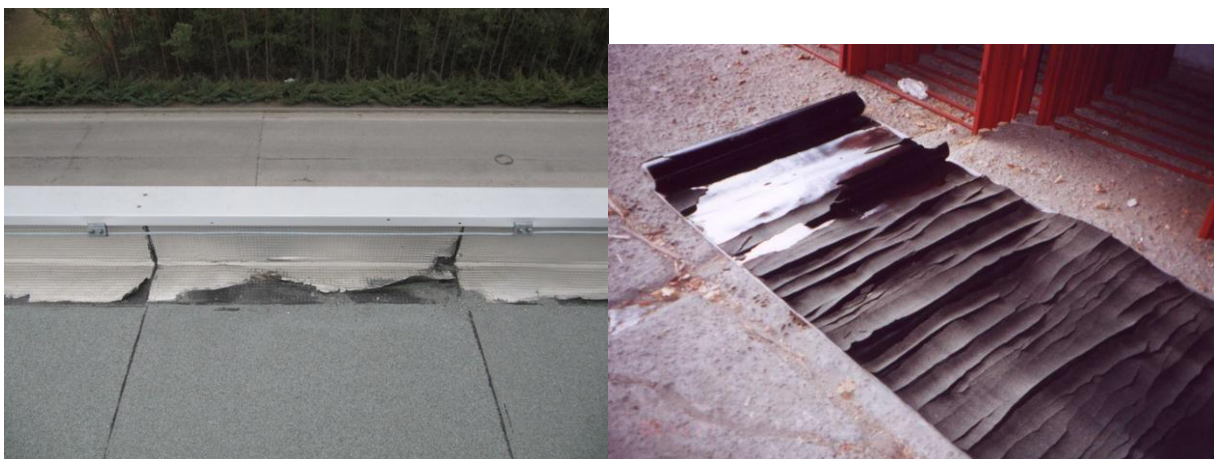
Obr. č. 184 – Delaminace vrchní hliníkové fólie od asfaltové hmoty, resp. delaminace krycí a spodní asfaltové vrstvy od al. výztužné vložky
