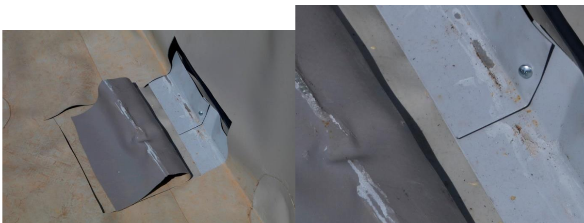
Obr. č. 134 – Naprosto nedostatečné přivaření fóliové hydroizolace k patnímu plechu
