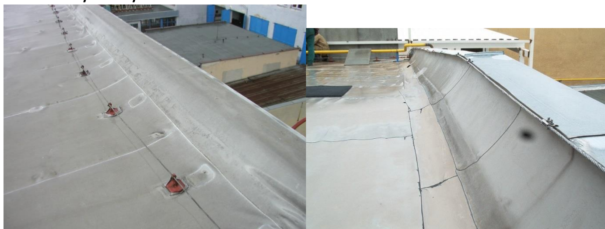
Obr. č. 98 – Smrštění u mechanicky kotvené fólie
