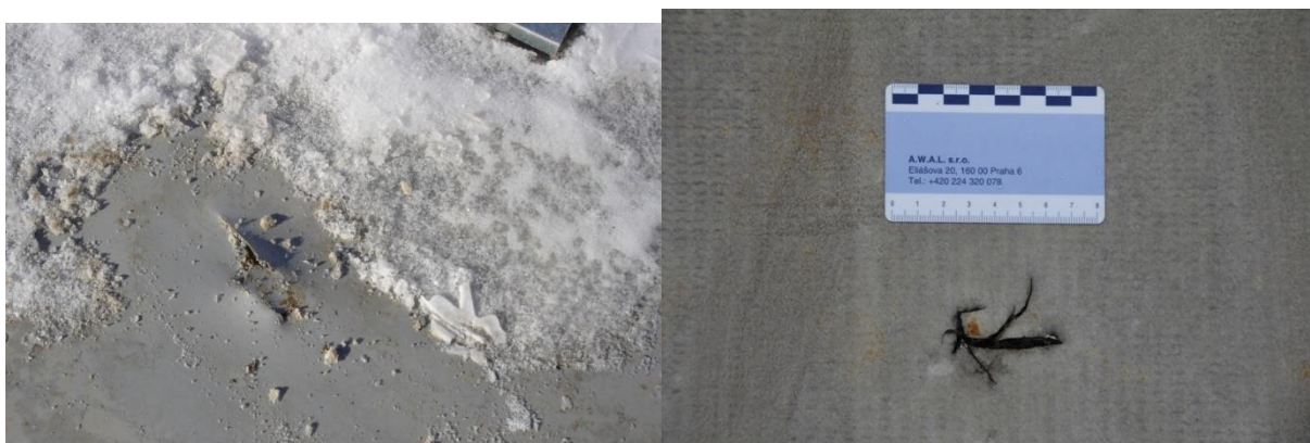
Obr. č. 109 – Mechanické poškození – proražení, fóliového hydroizolačního povlaku
