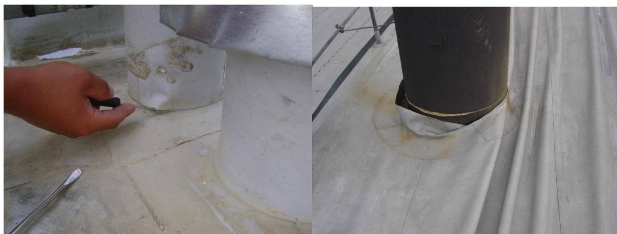
Obr. č. 150 – Jiný způsob opracování prostupu, ale též nesprávně, tedy netěsně provedený
