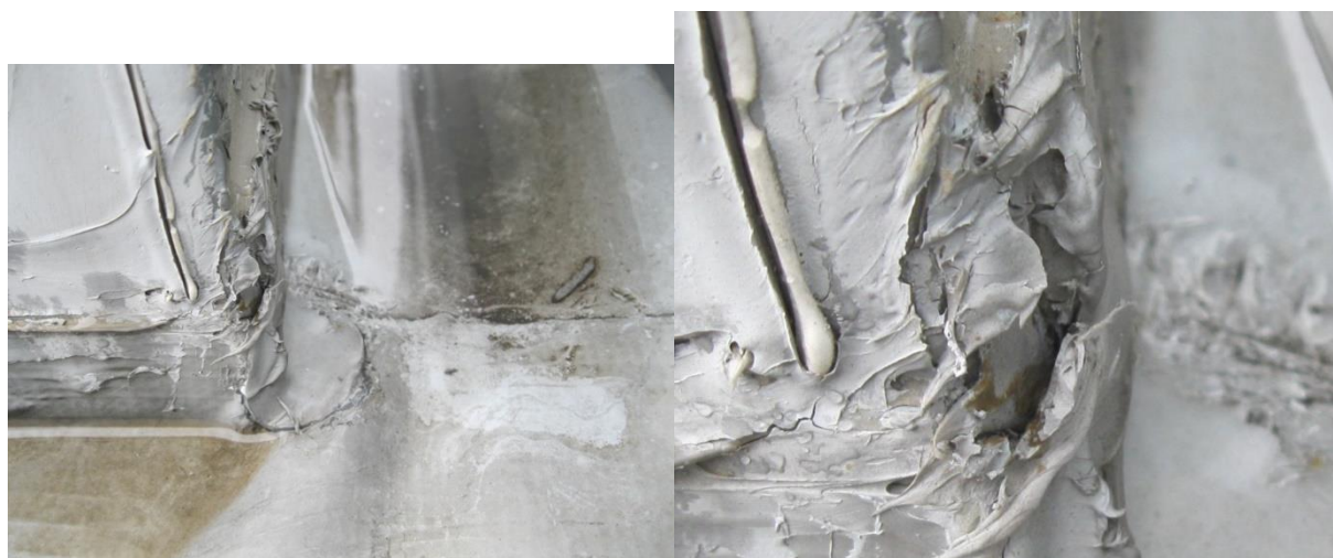
Obr. č. 121 – Nejen v ploše, ale i konstrukčních detailech u fólie PVC se lze setkat s „rozpatláním“ hydroizolační hmoty
