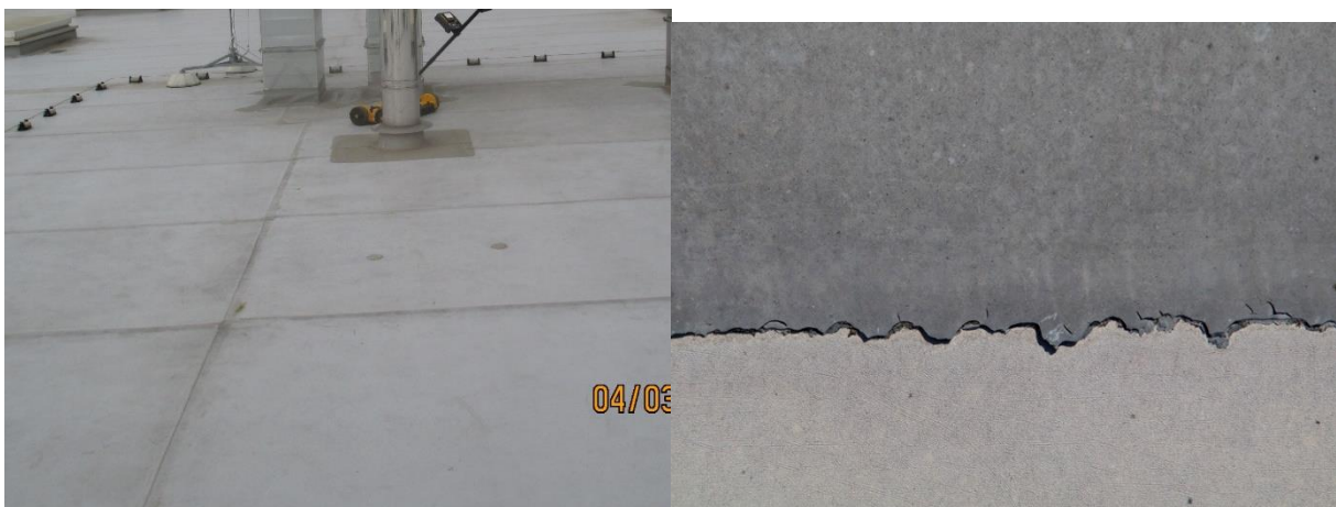
Obr. č. 115 – Dvě základní vady provádění – křížový spoja (vlevo), trhaná fólie (vpravo)
