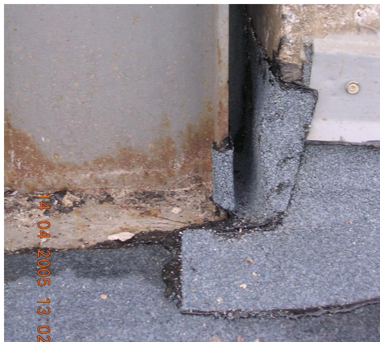
Obr. č. 223 – Stísněné místo mezi vzduchotechnikou a svislou konstrukcí se úspěšně hydroizolovat nedá
