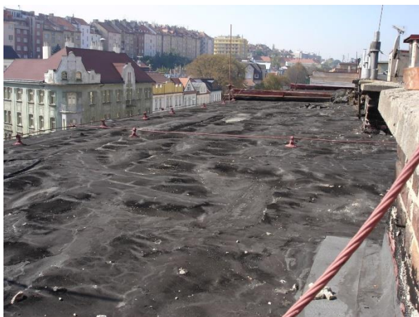
Obr. č. 62 – Střešní plášť z oxidovaných asfaltových natavovacích pasů – historické řešení, které je též za hranicí životnosti
