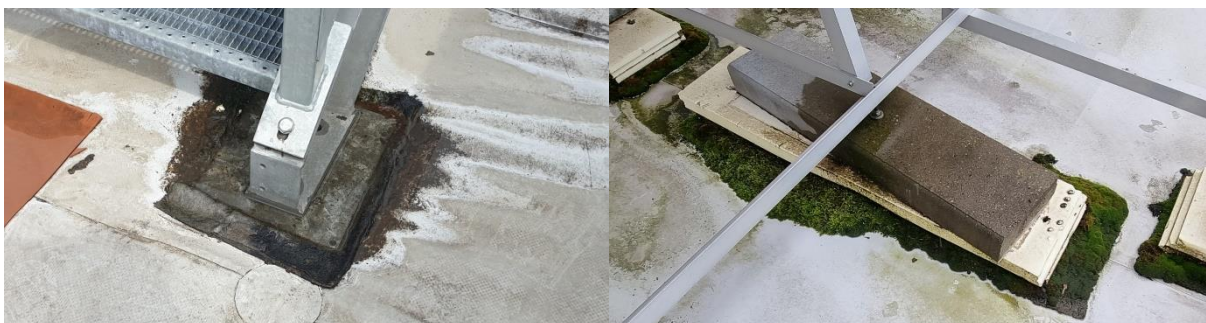
Obr. č. 8 – Zabořená schodnice do střešního pláště
