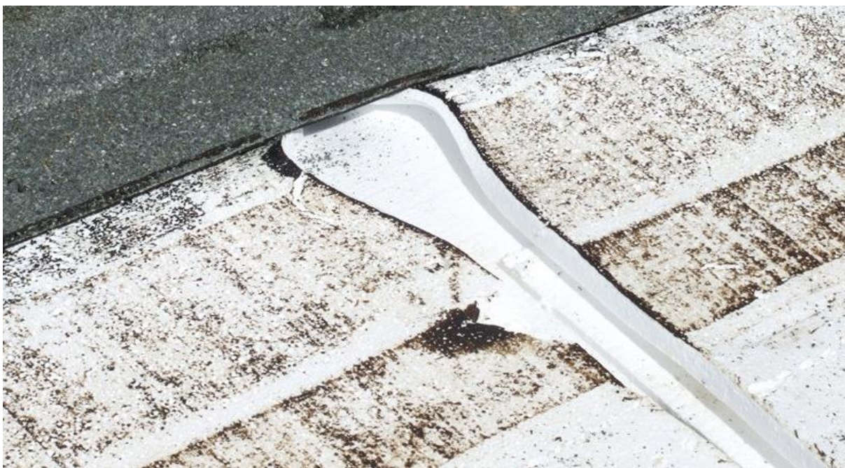
Obr. č. 59 – Zdegradovaná tepelná izolace v důsledku teploty, kterou již nemohla přenést
