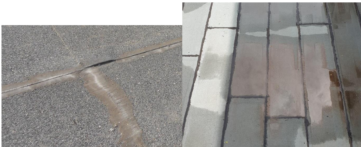
Obr. č. 212 – Toto je případ maskování nesvařené asfaltové hydroizolace pomocí asfaltového tmelu, kterým jsou přetřeny spoje, tedy místa, kde by měla být hydroizolace řádně svařena
