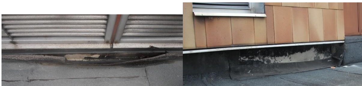
Obr. č. 218 – Hydroizolační povlak upadlý ze svislé konstrukce
