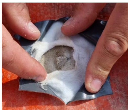
Obr. č. 53 – Šutr koukající z plochy betonu, tj. překročená hrubost podklad
