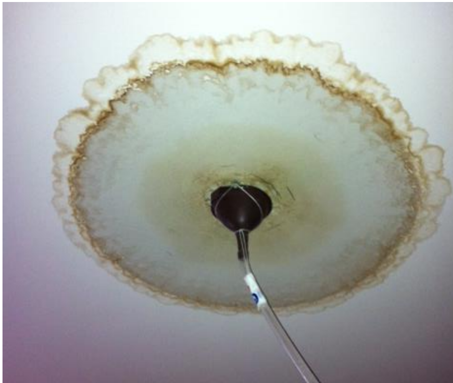
Obr. č. 22 – Zatékání do lustru (no nevím, jestli je el. proud slučitelný s vodou)
