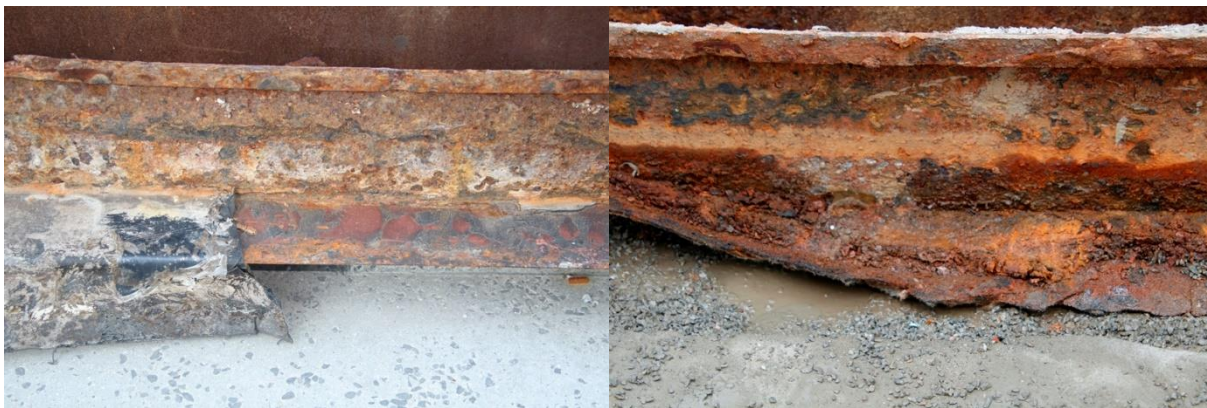
Obr. č. 46 – Příruba s ještě natavenou hydroizolací
