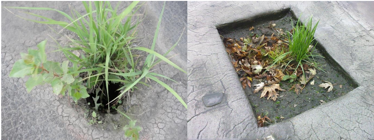
Obr. č. 253 – Vpust vykazující totální absenci údržby
