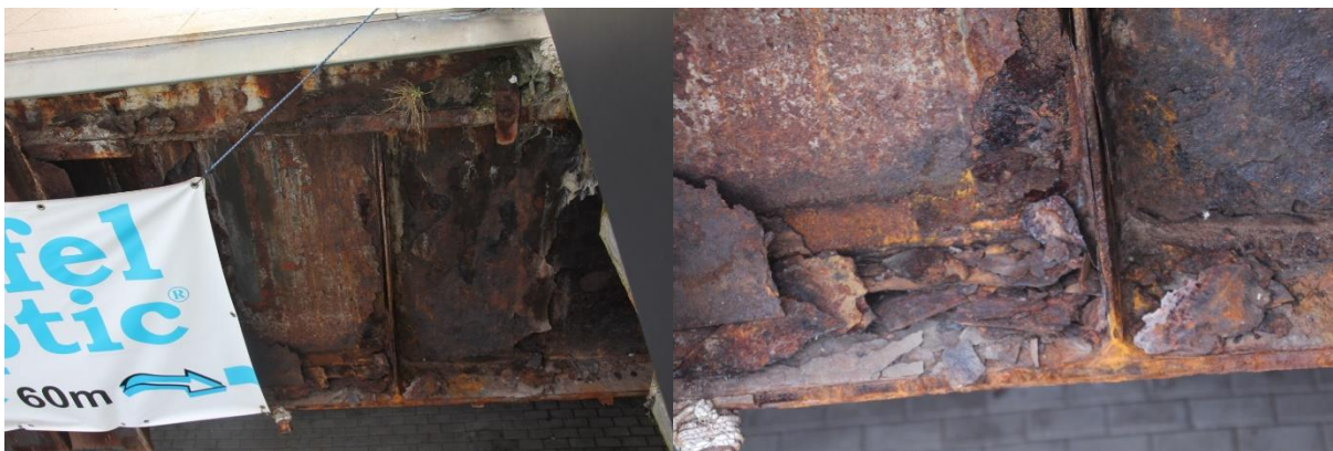
Obr. č. 37 – Zkorodovaná nosná konstrukce z ocelových prvků
