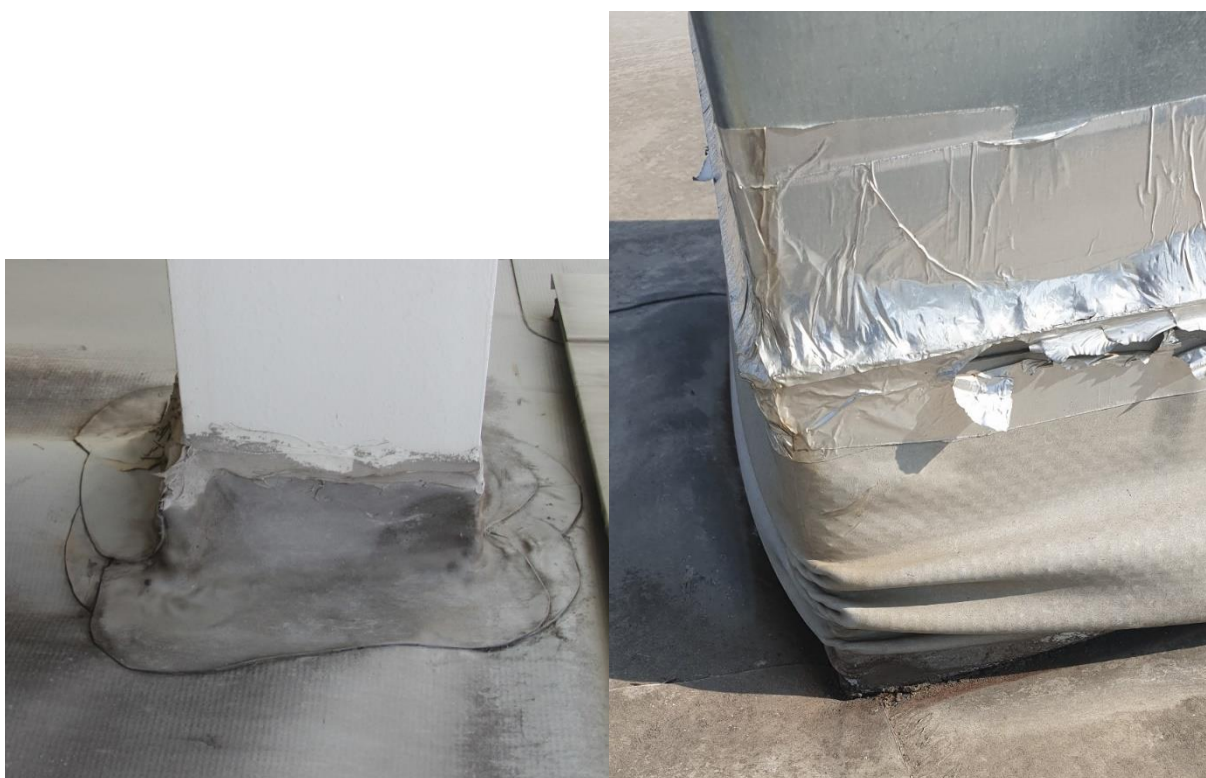
Obr. č. 143 – Nevhodné opracování hranatého prostupu
