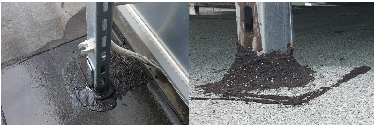
Obr. č. 7 – Nefunkční opravení nožiček technického zařízení budov
