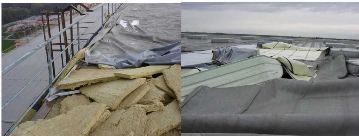
Obr. č. 128 – Střešní plášť zničený extrémní sací silou větru, dílo zkázy bylo umocněno použitím nevhodného mechanického kotvení
