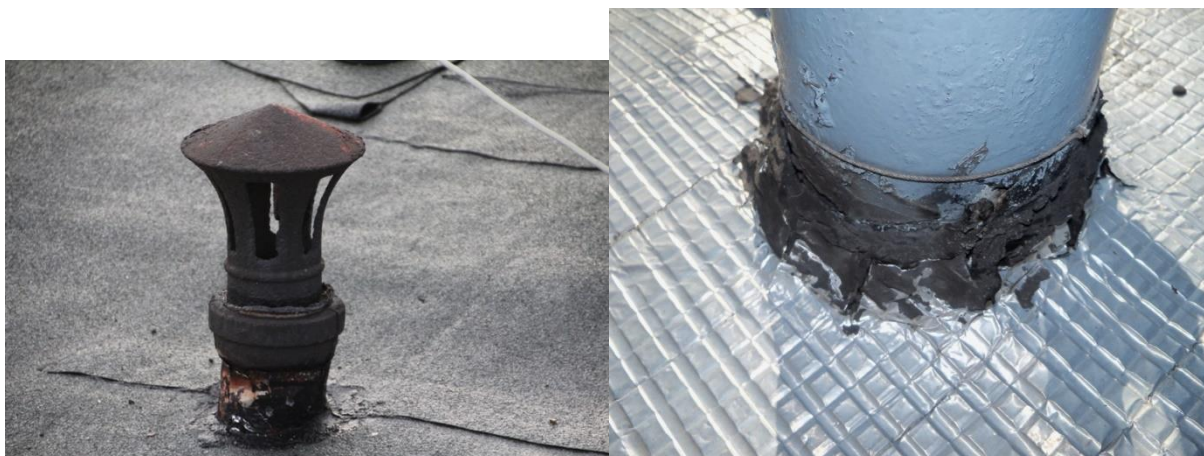
Obr. č. 228 – Při rekonstrukci byla hydroizolace pouze dorazena k původnímu prostupu, samotné opravy prostupu nebylo vůbec provedeno
