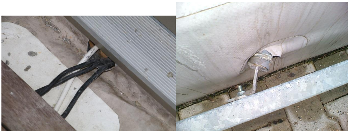
Obr. č. 158 – Kabelové prostupy v oblasti ukončení izolace na rámu dveří (důsledkem byla potopa v interiéru)
