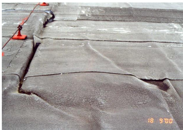
Obr. č. 57 – Deformace hydroizolace v důsledku deformace tepelné izolace
