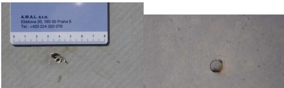
Obr. č. 110 – Mechanicky poškozená fólie při neopatrném vrtání
