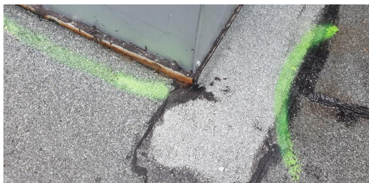
Obr. č. 221 – Absence vytažení hydroizolace na svislé konstrukce
