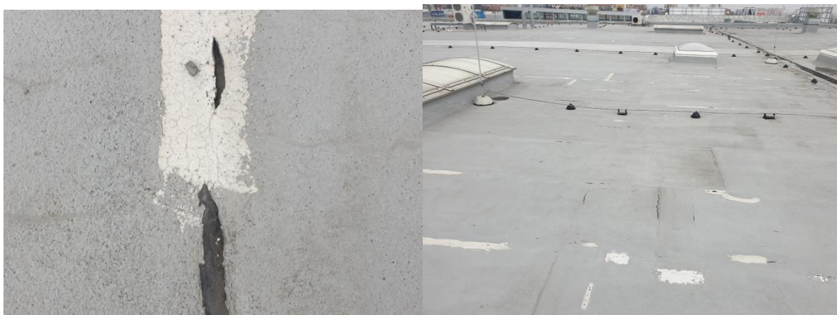
Obr. č. 82 – Marný pokus o sanační nátěr (první i druhý) na asfaltové hydroizolaci
