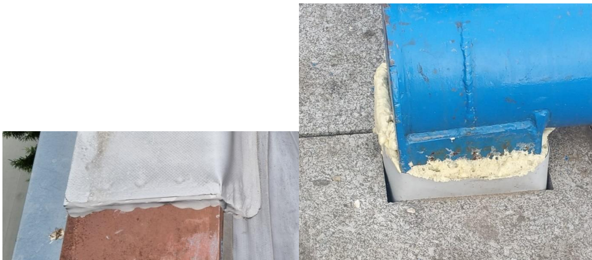
Obr. č. 165 – Pokus o napojení fóliové hydroizolace na zdegradovaný klempířský prvek
