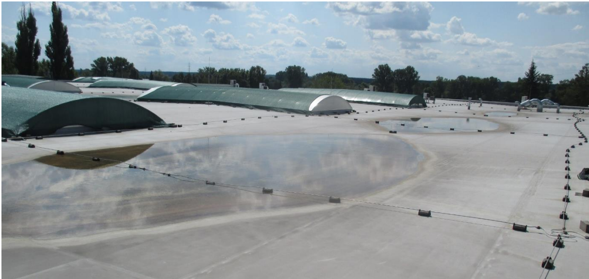
Obr. č. 11 – Statické poruchy (prohnutí nosné konstrukce mezi vpustmi)
