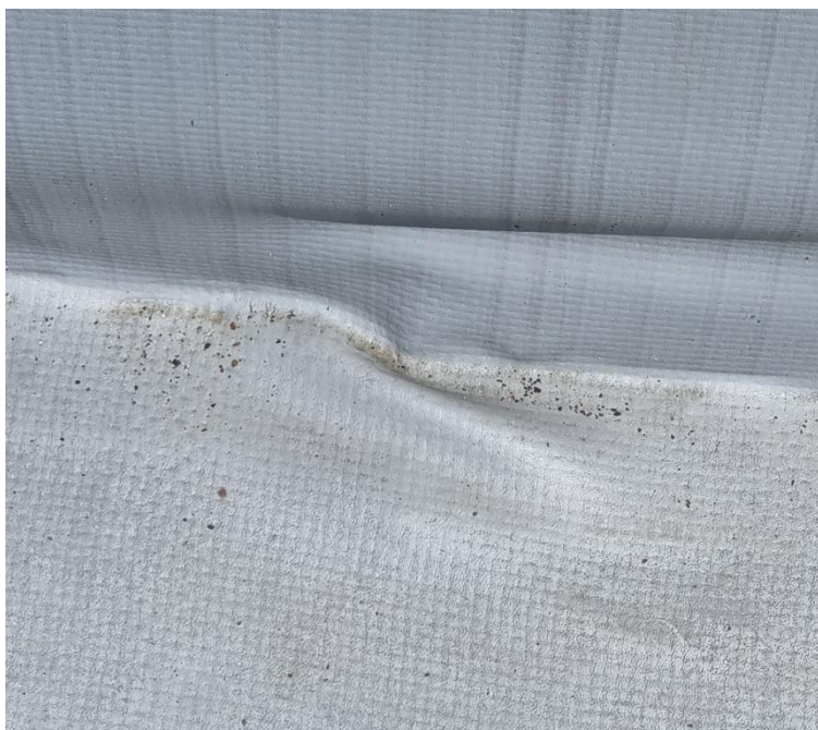
Obr. č. 133 – Dva díly patního plechu, které nejsou propojeny - proto dochází k porušení hydroizolace v místě jejich styku
