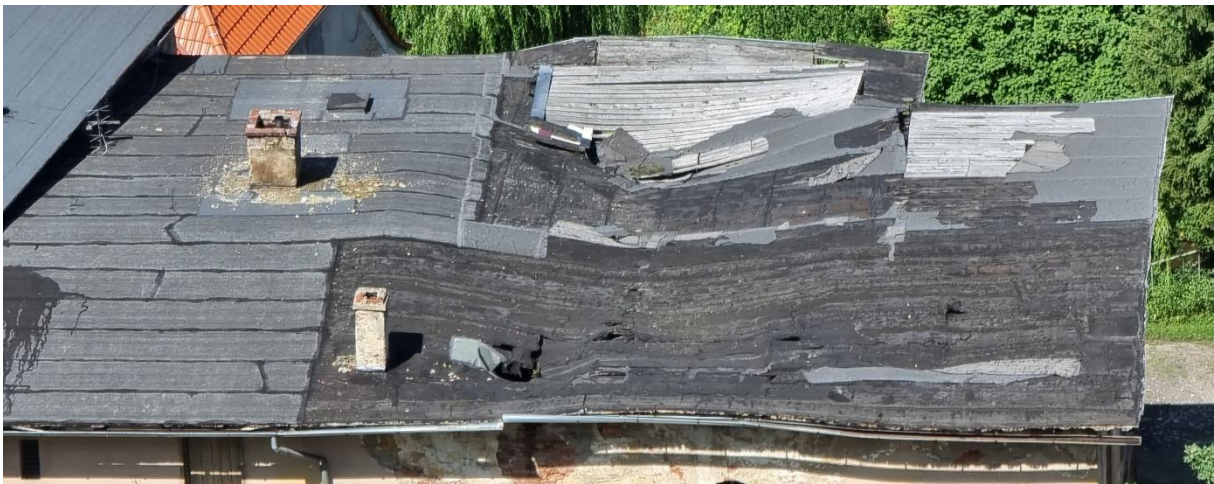
Obr. č. 13 – Destrukce nosných konstrukcí v důsledku dlouhodobého zatékání
