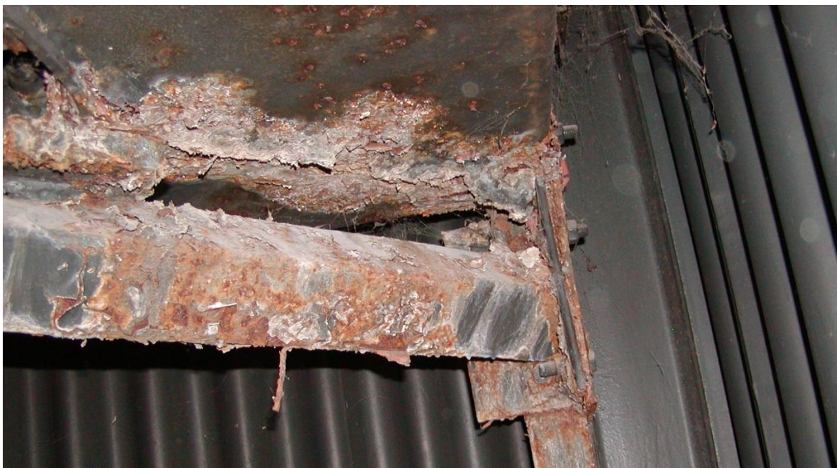
Obr. č. 39 – Koroze nosné konstrukce střešního pláště v důsledku dlouhodobého zatékání
