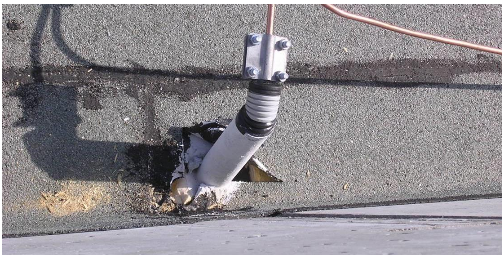
Obr. č. 243 – Dnešní praxe na střeších - i takto může vypadat prostup
