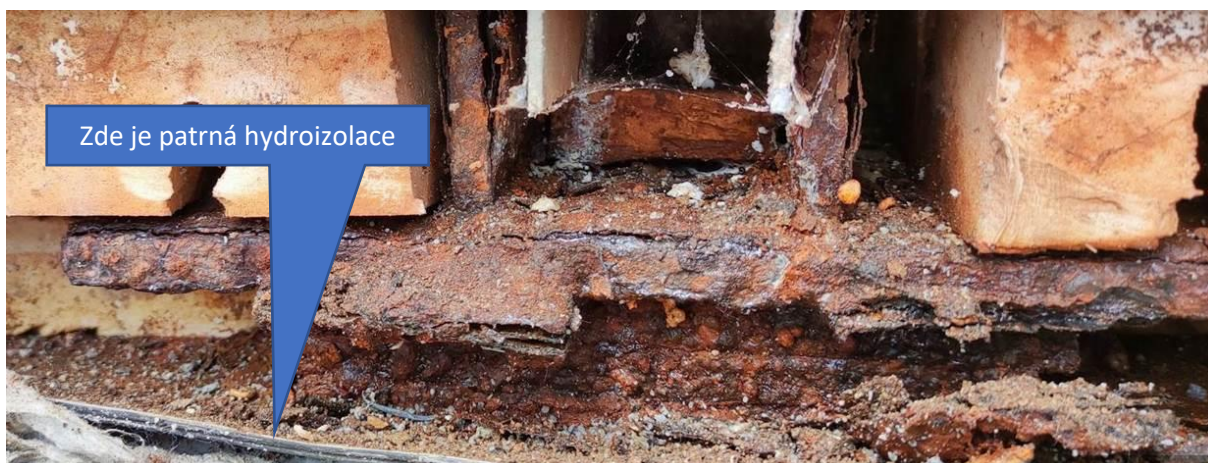
Obr. č. 49 – Takto vypadá zkorodovaný nosník fasády, v případě, že není dokonale izolován a je plně vystaven působení vody, včetně rozmrazovacích prostředků
