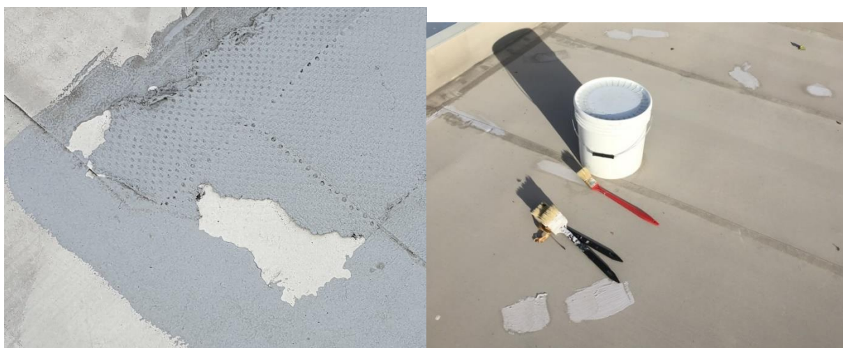
Obr. č. 81 – Marný pokus o provedení sanačního nátěru na fóliovou hydroizolaci
