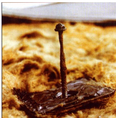
Obr. č. 41 – Konečná fáze koroze mechanického kotvení
