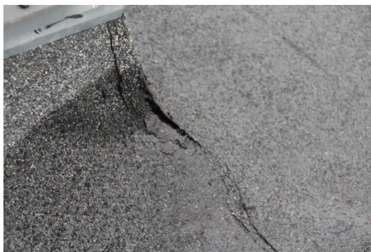
Obr. č. 189 – Doprovodný jev sjíždění hydroizolací – její delaminace
