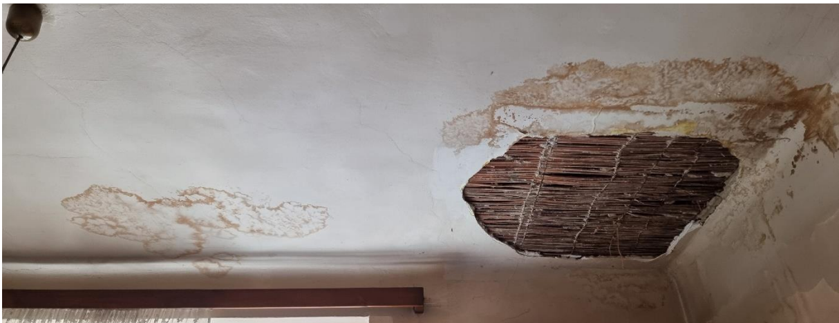
Obr. č. 14 – Masivní a dlouhodobé zatékání do stropní konstrukce s odpadáním vnitřní omítky
