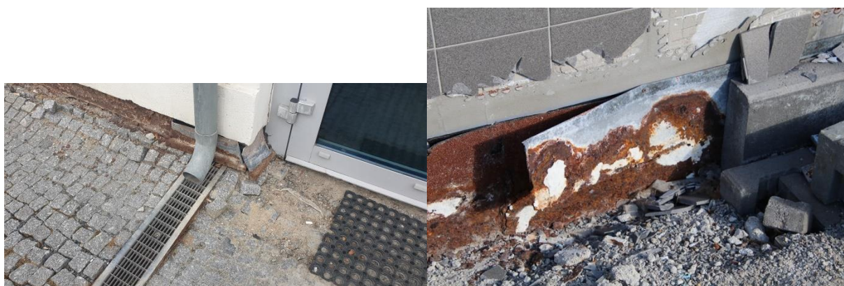
Obr. č. 50 – Koroze ochranných klempířských prvků
