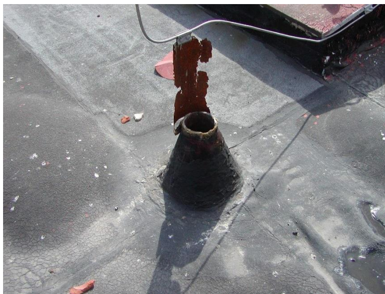
Obr. č. 52 – Příklad totální koroze ocelové trubky, ovšem opracování jejího kruhového prostupu pomocí oxidovaných asfaltových pásů je bezchybné
