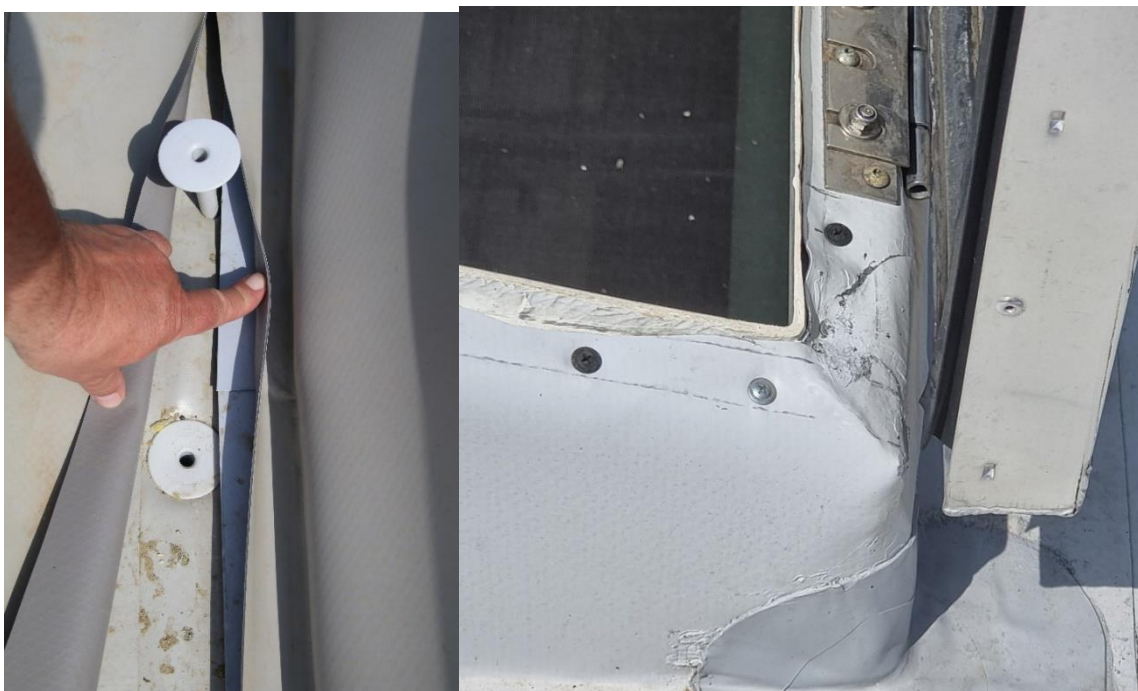
Obr. č. 131 – Nesprávné kotvení fóliových plechů, protože jsou drženy pouze talířky hmoždinek, což je samozřejmě nedostatečné
