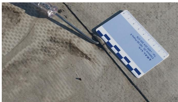
Obr. č. 116- Základní vada provádění – nedovarek (v tomto případě kompletní, na celou velikost kontrolního háčku)
