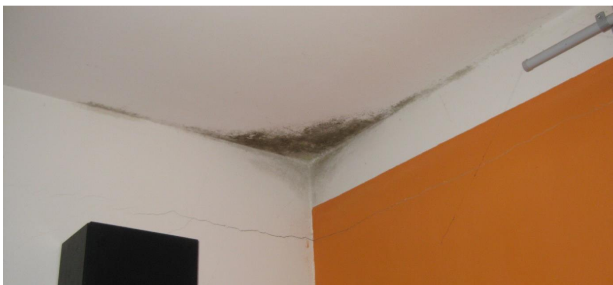
Obr. č. 27 – Ukázkový příklad kondenzace v koutě obytné místnosti v důsledku tepelného mostu
