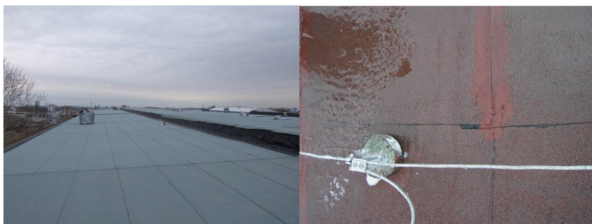
Obr. č. 205 – Snímek zachycuje základní izolačerskou neznalost - založení pasů na stříh je základním signálem, že prováděcí firma svou práci neuměla
