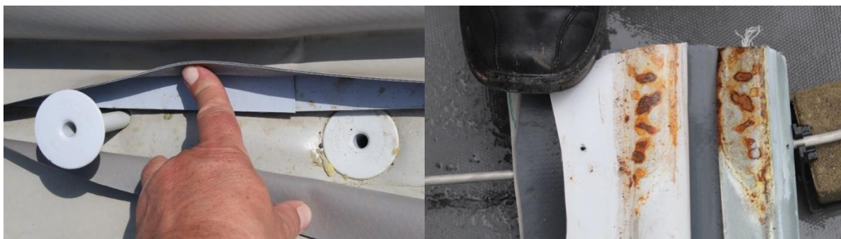
Obr. č. 135 – Zcela nevhodné mechanické kotvení patního úhelníku a koroze tohoto patního úhelníku
