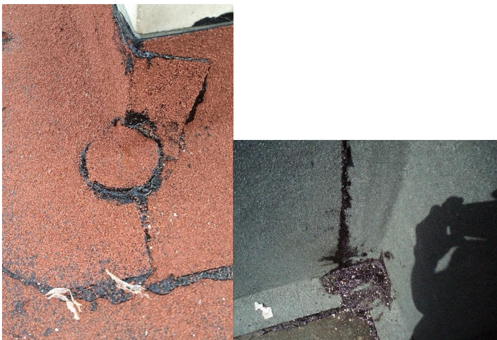
Obr. č. 215 – Naprosto špatné provedení koutu, včetně zesilující tvarovky
