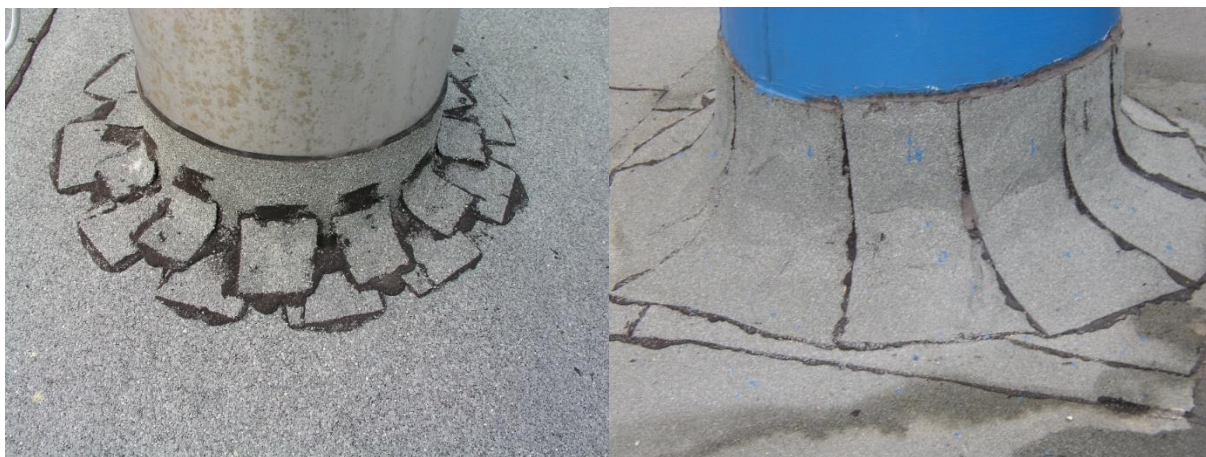
Obr. č. 225 – Opracování prostupu typu „český hračička“ je samozřejmě nesystémové a nefunkční
