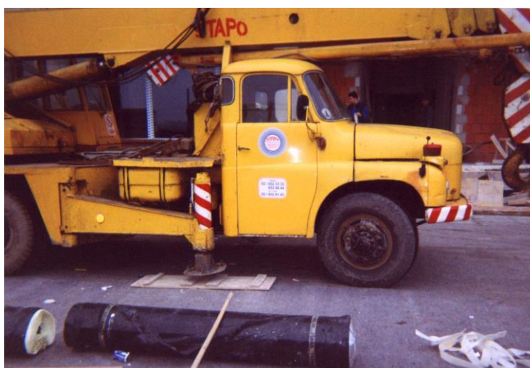
Obr. č. 202 – Autojeřáb na hotové a nechráněné hydroizolaci je také zárukou budoucích problémů
