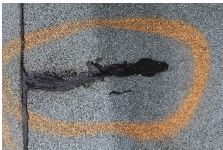
Obr. č. 198 – Mechanicky poškozený hydroizolační pás, neodborně spravený pouhým rozšpachtlováním
