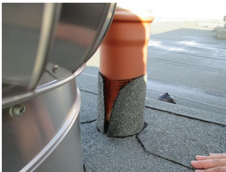
Obr. č. 227 – Oprava prostupu asfaltovým pásem bez stažení páskem, navíc na prostup z tvrdého PVC
