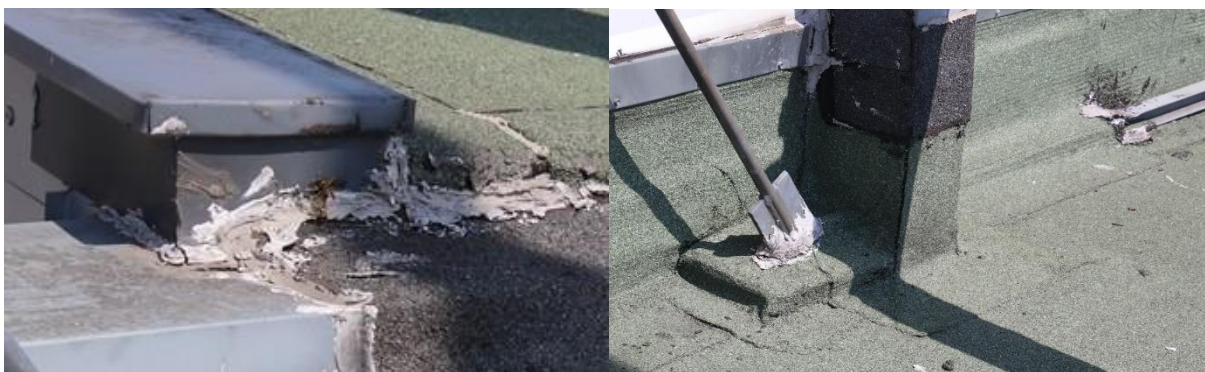
Obr. č. 250 – Detail atiky z předchozího obrázku s jasně patrným „patlacím“ systémem opravy
