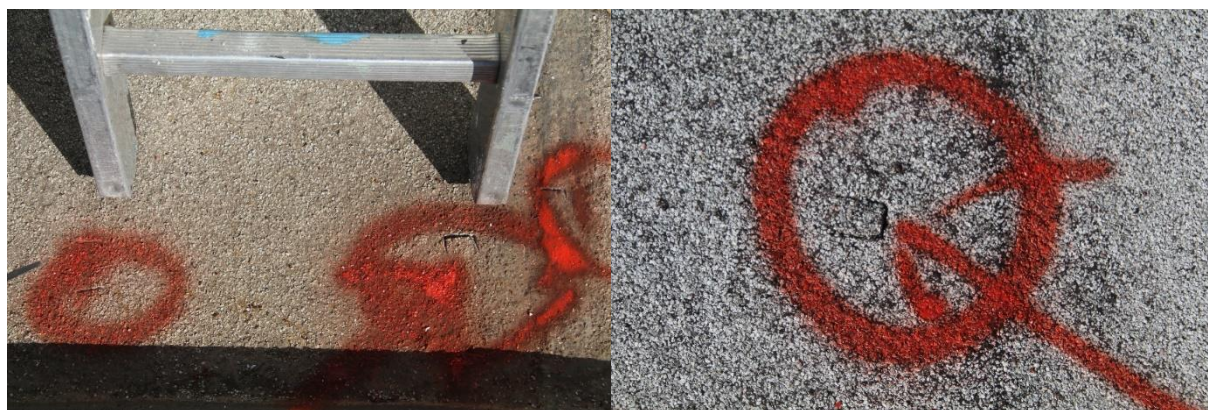
Obr. č. 204 – Mechanické poškození asfaltového hydroizolačního povlaku od žebříku, který neměl zaslepené stojiny
