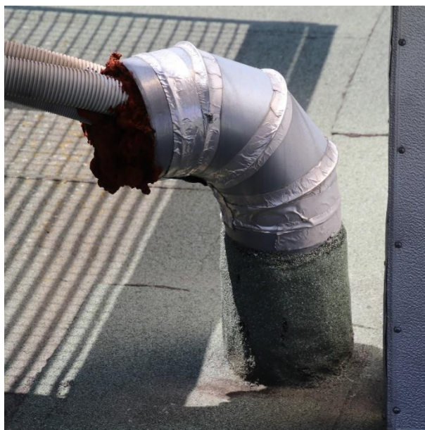
Obr. č. 241 – Tvarové možnosti špatných řešení kabelových vstupů jsou prakticky nekonečné
