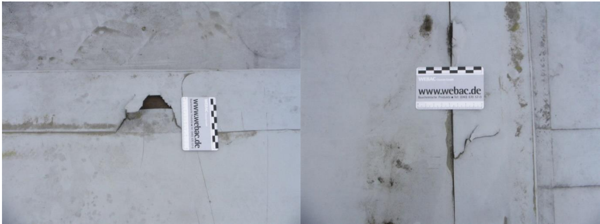
Obr. č. 113 – Typické mechanické poškození při neodborném odklízení sněhu
