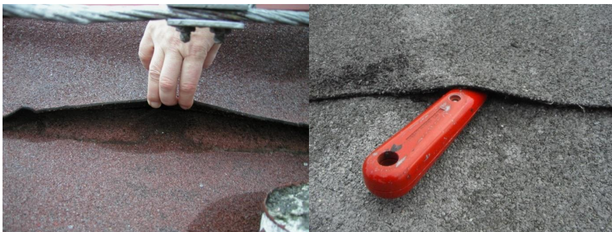
Obr. č. 207 – Hydroizolační povlak není řádně svařený, je patrné nezatlačení ochranného posypu asfaltového pásu
