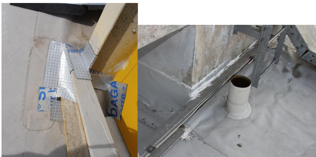
Obr. č. 161 – Místo stěrkové izolace je zde použita samolepící izolace, která sice na začátku funguje, ale její životnost je extrémně krátká
