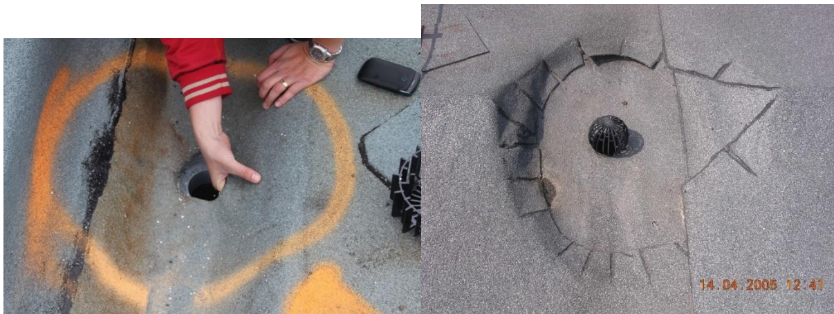
Obr. č. 246 – Nenařazení hydroizolačního povlaku na integrovaný límec vpusti z asfaltového pásu
