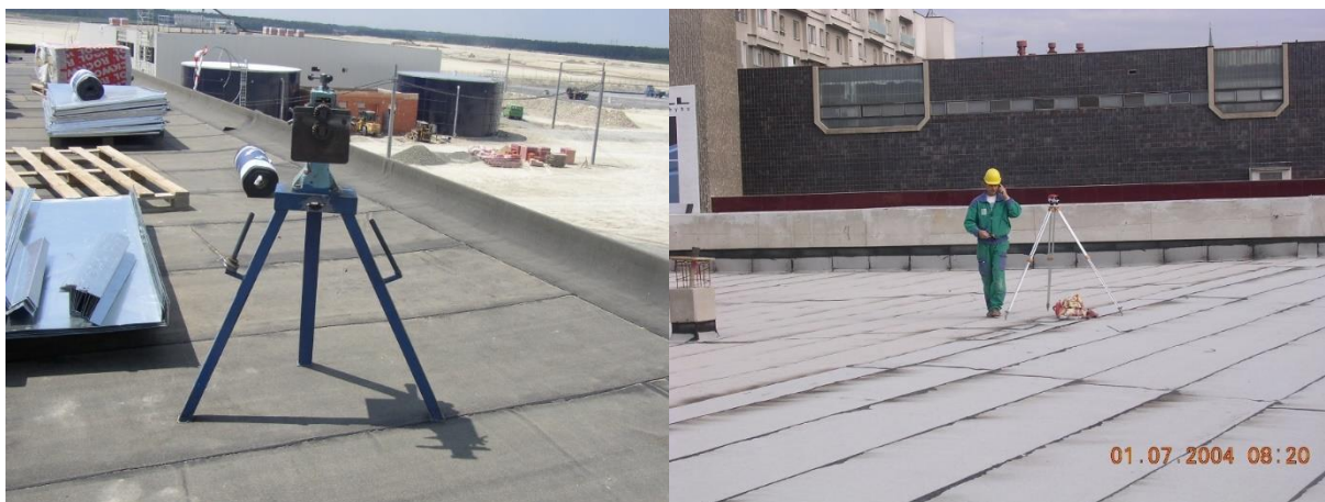
Obr. č. 200 – Hydroizolační povlak namáhaný následnými řemesly, v tomto případě hotovou hydroizolací ignorovali klempíři
