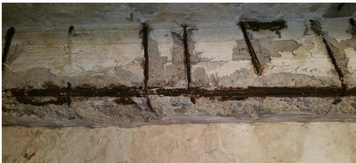
Obr. č. 17 – Dlouhodobé zatékání v kombinaci s mrazem dokáže zničit prakticky každou konstrukci, samozřejmě včetně železobetonové
