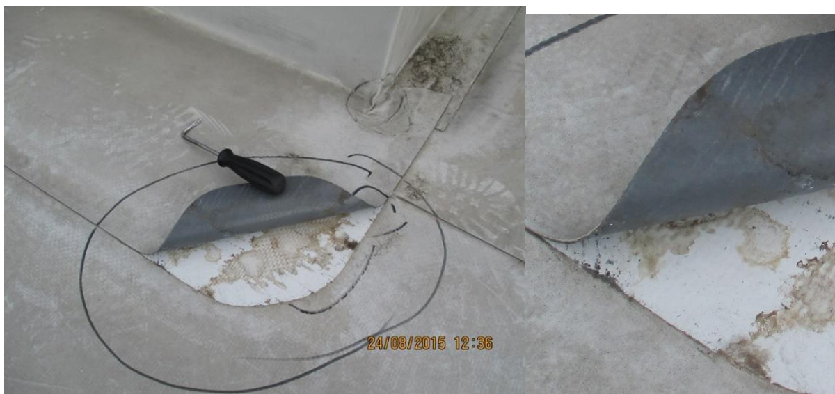
Obr. č. 117 – Nedostatečné svaření, spíše slepení hydroizolačních fólií
