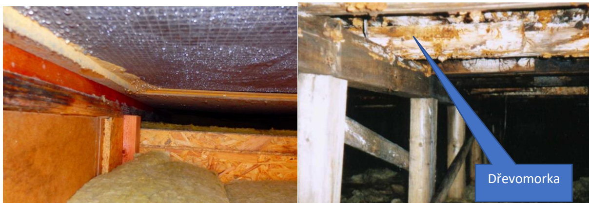
Obr. č. 26 – Kondenzace na vnitřním povrchu pojistné hydroizolace, počátek hniloby dřevěných konstrukcí
