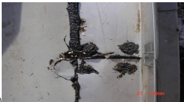
Obr. č. 137 – Utěsnění spojů fóliové izolace pomoc asphaltového tmelu (toto řešení je oblíbené, ale absolutně nepřijatelné, protože oba materiály jsou neslučitelné)
