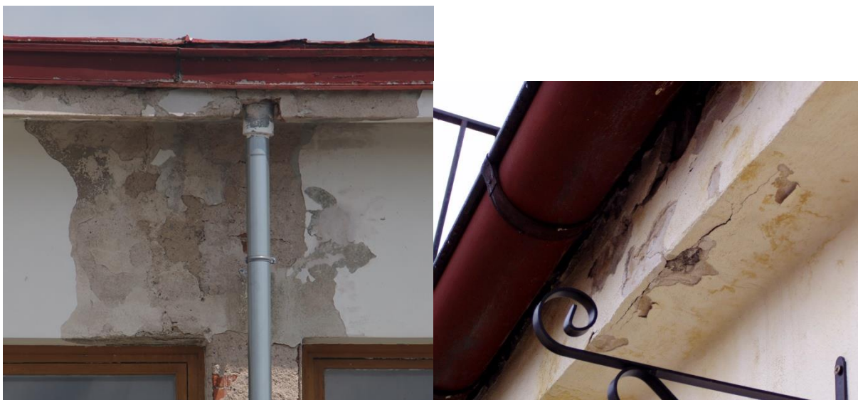
Obr. č. 23 – Masivní vnější zatékání do římsy pod střechou
