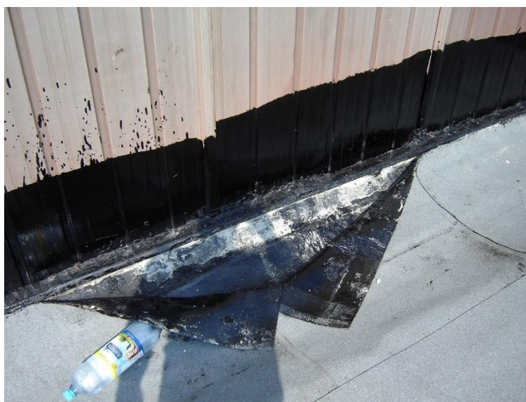
Obr. č. 216 – Nedostatečné navaření hydroizolace při vytažení na svislou konstrukci
