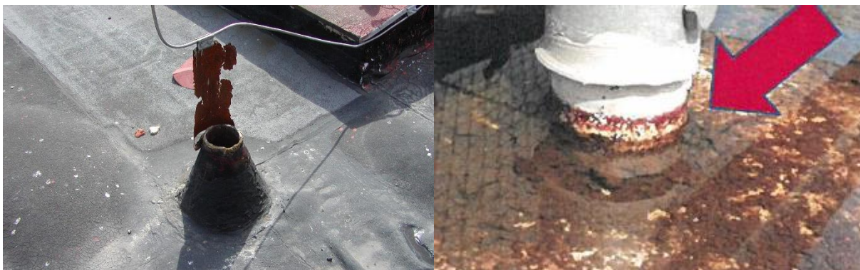
Obr. č. 47 – Tzv. totální koroze odvětrávacího komínku, resp. koroze základu prostupu u kterého dlouhodobě stála voda
