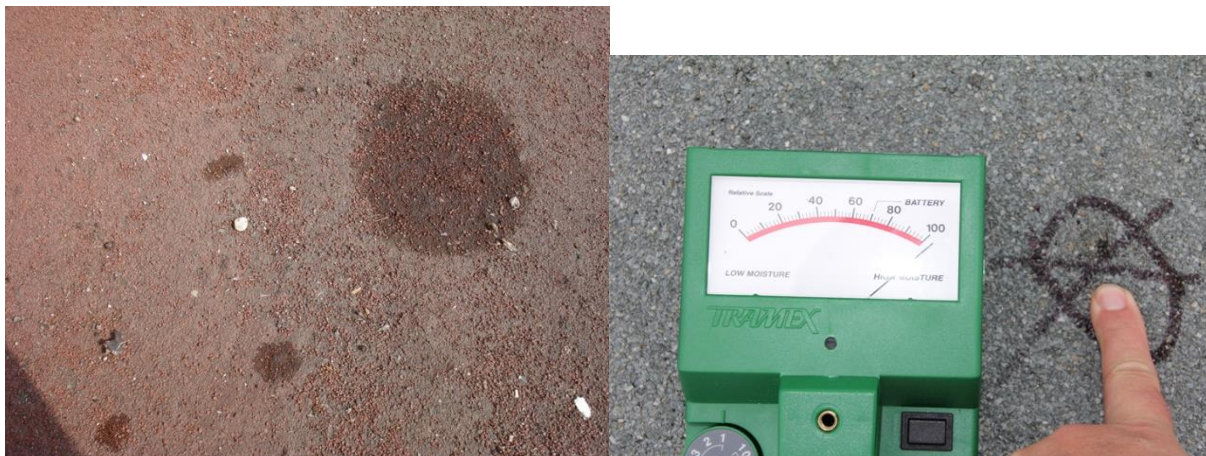
Obr. č. 185 – Prosakování vody vrchní vrstvou asfaltu
