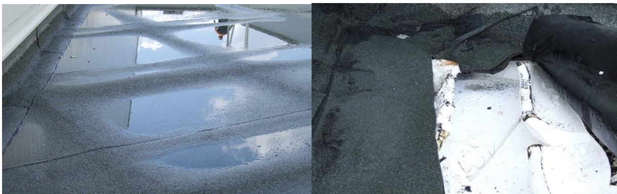
Obr. č. 58 – Zdeformovaná hydroizolace v důsledku degradace tepelné izolace
