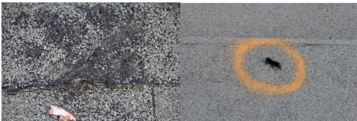
Obr. č. 197 – Mechanicky poškozená asfaltová hydroizolace
