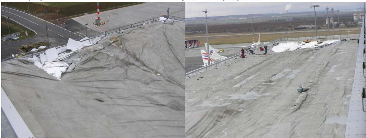
Obr. č. 127 – Zničený střešní plášť v důsledku extrémního sání větru
