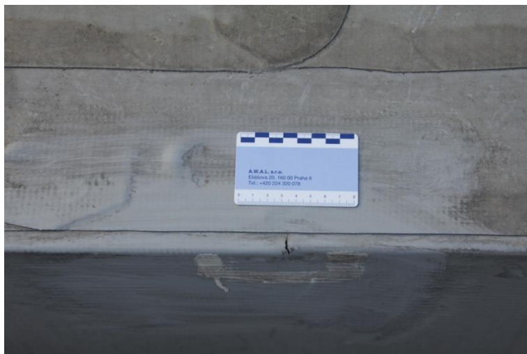
Obr. č. 100 – Trhlina v syntetické fólii na styku dvou podkladních poplastovaných plechů
