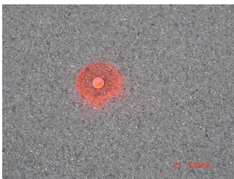
Obr. č. 201 – Geodeti nepoškozuji hydroizolace jen trojnožkami přístrojů, ale také hřebíčky, kterými si označují své zájmové body (geodetické hřebíčky jsou pak hřebíčky do rakve těsnosti vodotěsných izolací)
