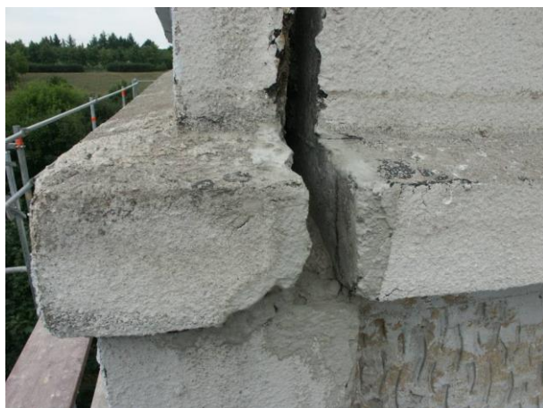
Obr. č. 15 – U panelových objektů může dojít, při dlouhodobém zatékání k destrukci spojů jednotlivých panelů
