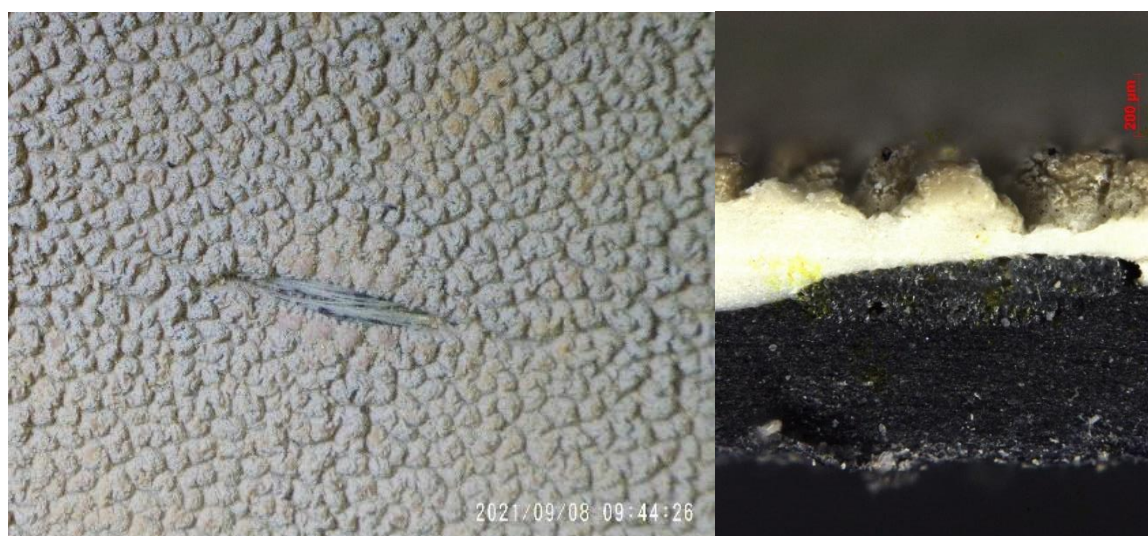
Obr. č. 96 – Trhlina v zdegradovaném povrchu fóliové izolace
