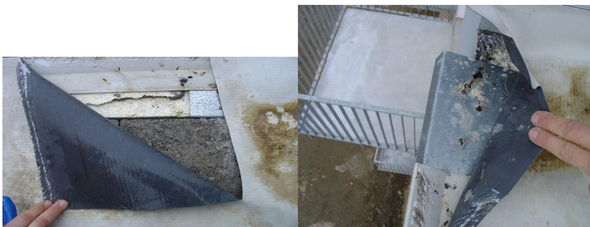
Obr. č. 136 – Nedostatečné navaření na fóliové plechy v kombinaci s přímým kontaktem s pěnovým polystyrénem, který není dlouhodobě slučitelný s PVC fólií
