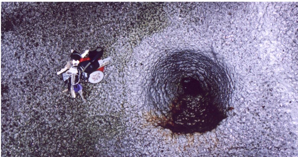
Obr. č. 73 – Totálně zastříkaná vpust při sanaci střešního pláště právě stříkanými polyuretany
