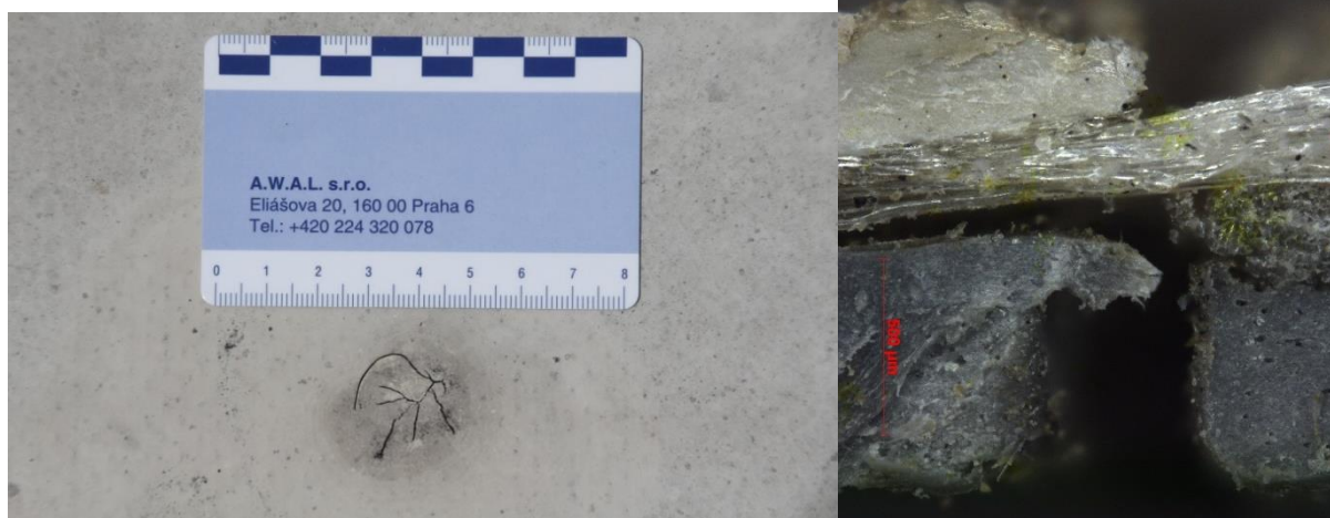
Obr. č. 103 – Detail proražení hydroizolačního povlaku dopadajícími kroupami
