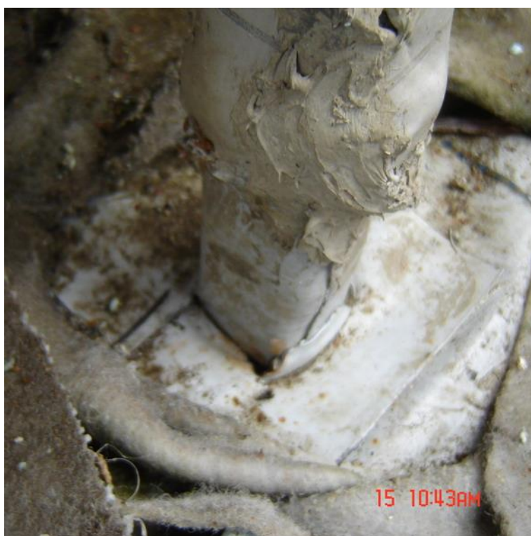
Obr. č. 145 – Tmelem opatlaný nekrhový prostup je samozřejmě netěsný
