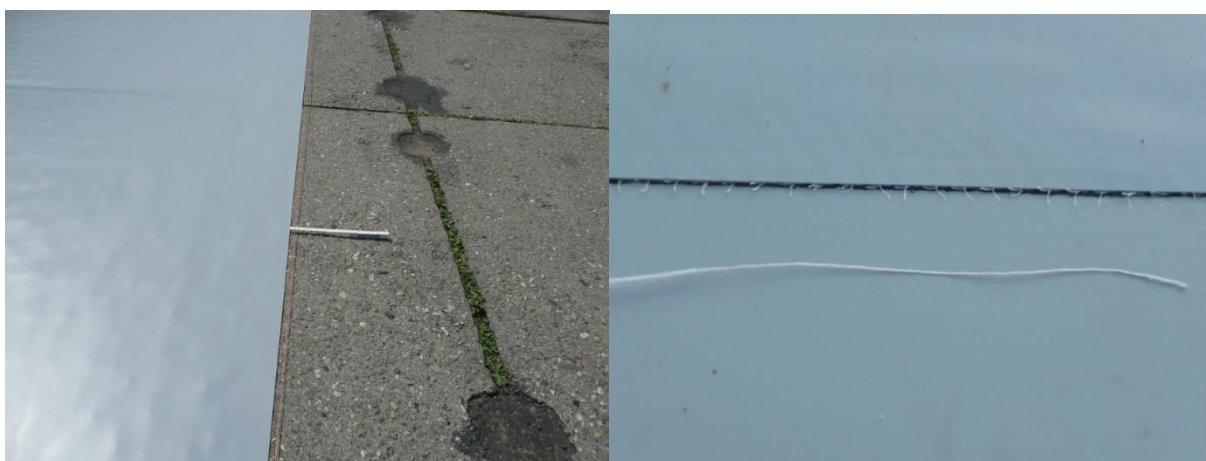
Obr. č. 85 – Typický příklad šavlovitosti vyrobeného fóliového materiálu
