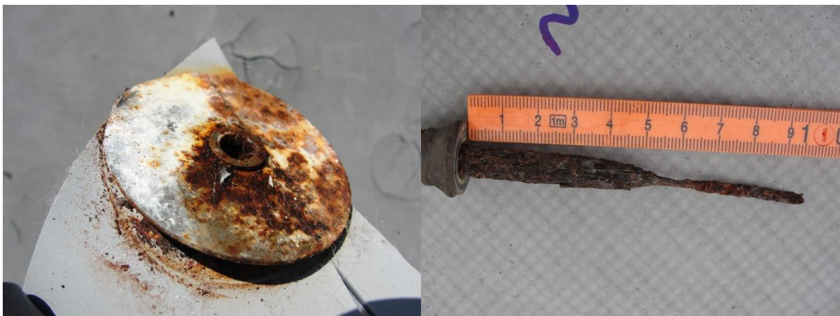
Obr. č. 40 – Těsně předkonečné stádium koroze mechanického kotvení
