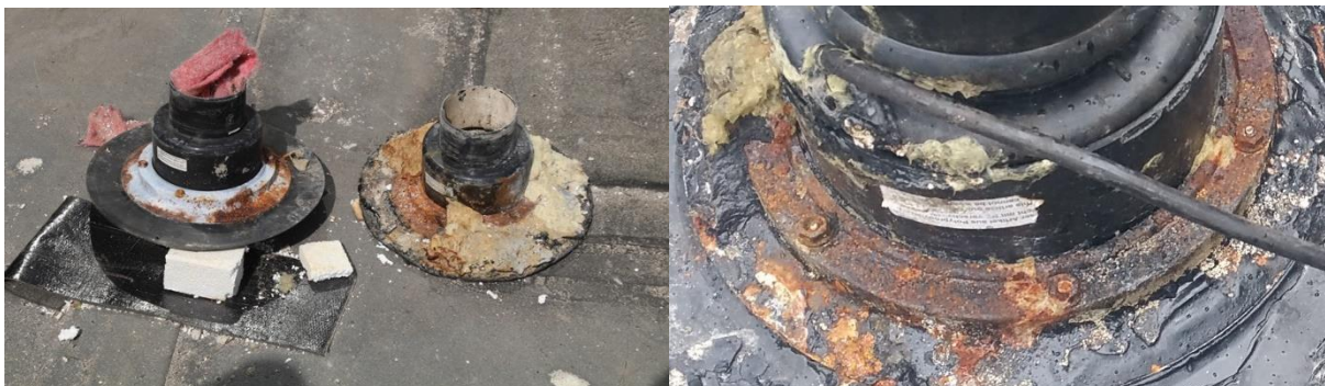
Obr. č. 43 – Zkorodované vpusti (po pěti letech od realizace)
