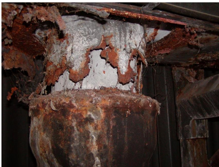
Obr. č. 44 – Koroze ocelových vpustí – těsnost zajišťují výluhy, které ještě ne zcela ucply tyto vpusti
