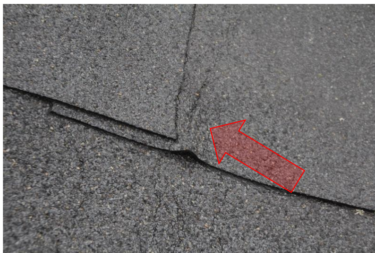
Obr. č. 210 – Další příklad hubičky vzniklé při navařování hydroizolačního povlaku
