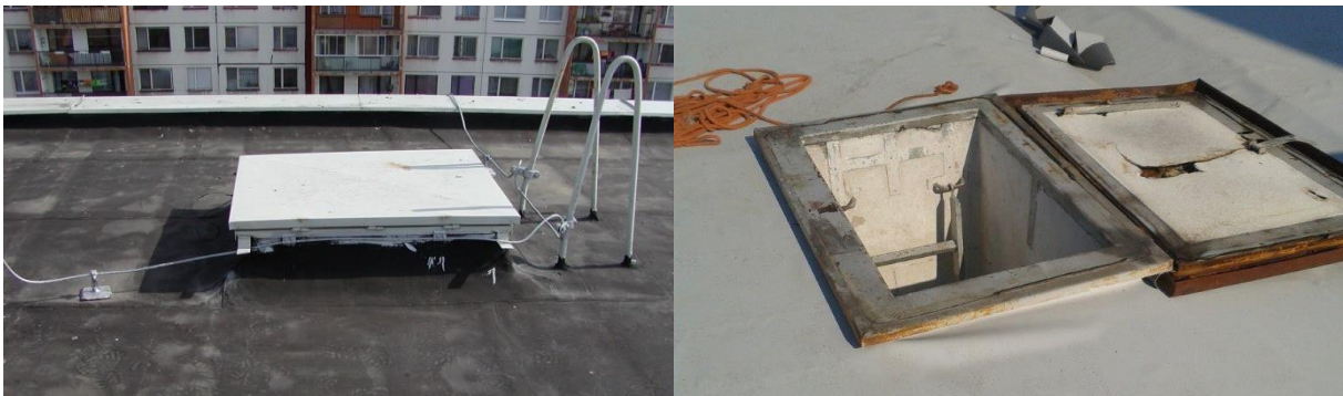
Obr. č. 3 – Výlez na střechu v původním technickém, resp. zatepleném stavu (bez ohledu na vytažení izolace nad úroveň střechy)
