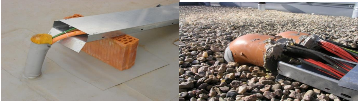
Obr. č. 154 – Kabelový vstup
