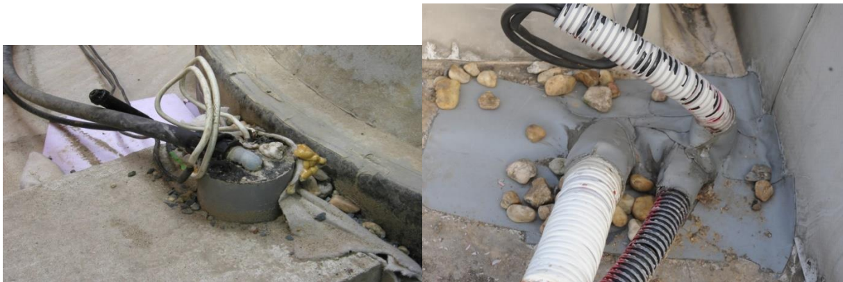
Obr. č. 155 – Kabelový vstup
