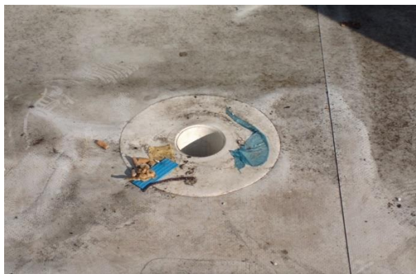
Obr. č. 166 – „Měkká“ vpust, špatně osazená
