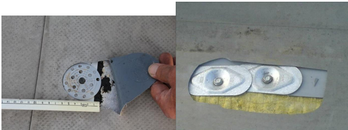
Obr. č. 129 – Použito je chybně mechanické kotvení, určené pro zateplení fasád
