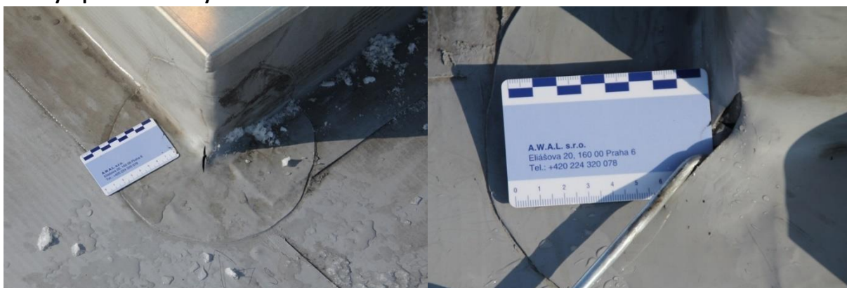
Obr. č. 101 – Detail a celkový pohled na trhlinu v rohu fóliového hydroizolačního povlaku
