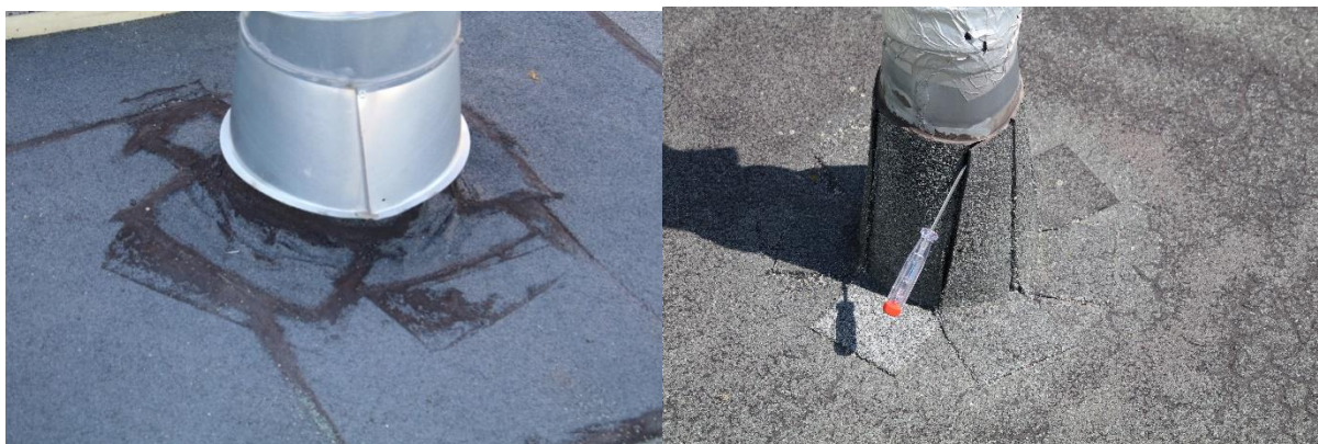
Obr. č. 226 – Také tento způsob opravy kruhového prostupu je špatný
