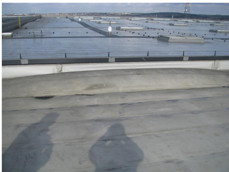
Obr. č. 125 – Nedostatečné mechanické kotvení v obvodové partii střešního pláště
