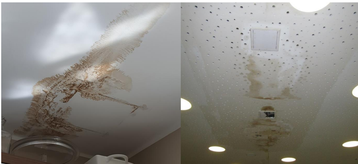
Obr. č. 19 – Masivní zatékání do sádkartonového podhledu
