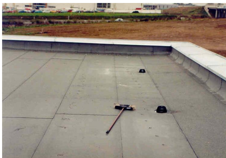
Obr. č. 199 – Mechanicky poškozený asfaltový hydroizolační povlak
