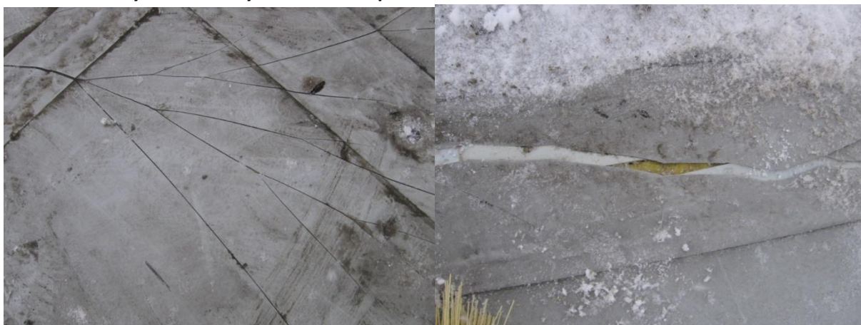
Obr. č. 107 – Mrazové trhliny syntetických fólií
