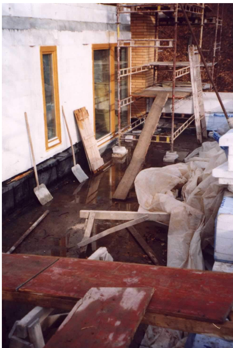
Obr. č. 196 – Skladiště všeho možného na hydroizolaci, je vždy příčinou její perforace
