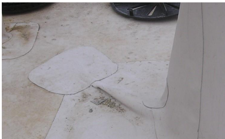
Obr. č. 141 – Špatně provedené napojení přířezu fólie, ze kterého je prostup opracován, k fólii
