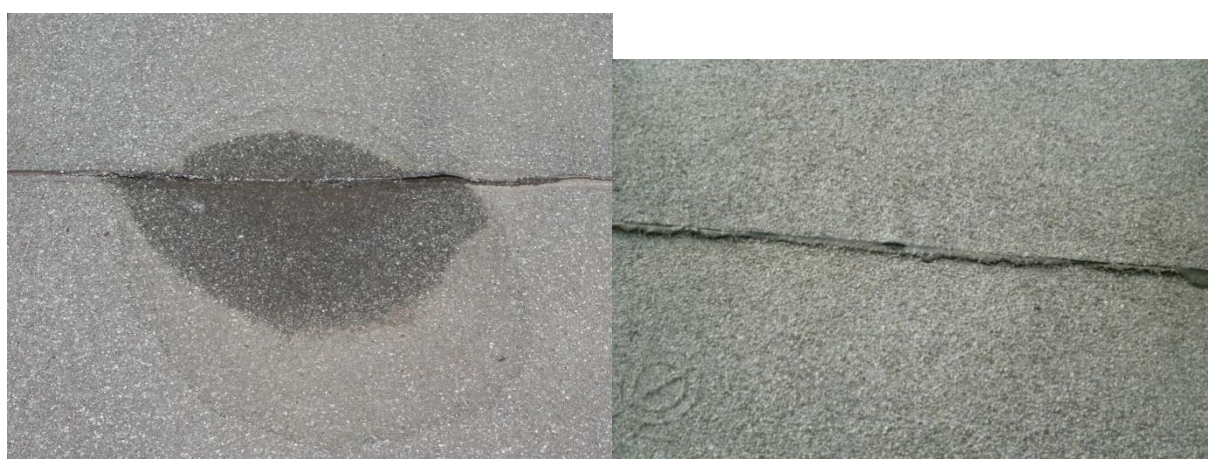
Obr. č. 209 – Netěsnost ve svaru přesahu hydroizolačního povlaku se zde projevuje vytékáním vody z přesahu
