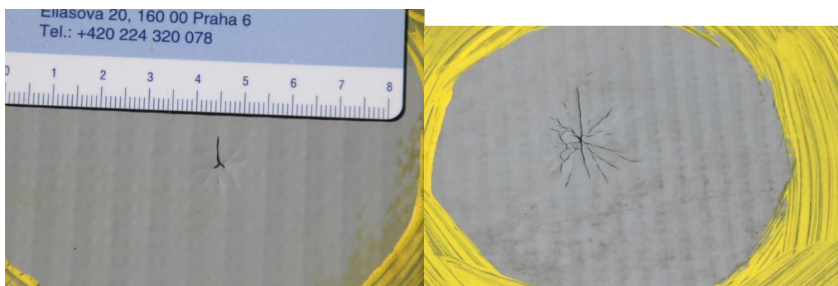
Obr. č. 93 – Paprskovitá prasklina je typickým příkladem degradace fóliového hydroizolačního materiálu PVC v důsledku lokální migrace změkčovadel
