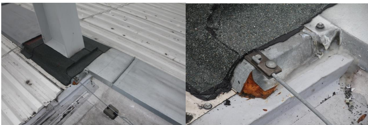
Obr. č. 251 – Naprosto nevhodné technologické propojení, a to asfaltových pasů, syntetických fólií a plechové profilované krytiny
