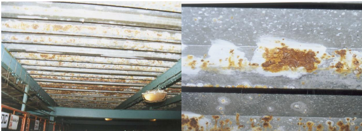
Obr. č. 38 – Zkorodovaná nosná konstrukce z profilovaných plechů
