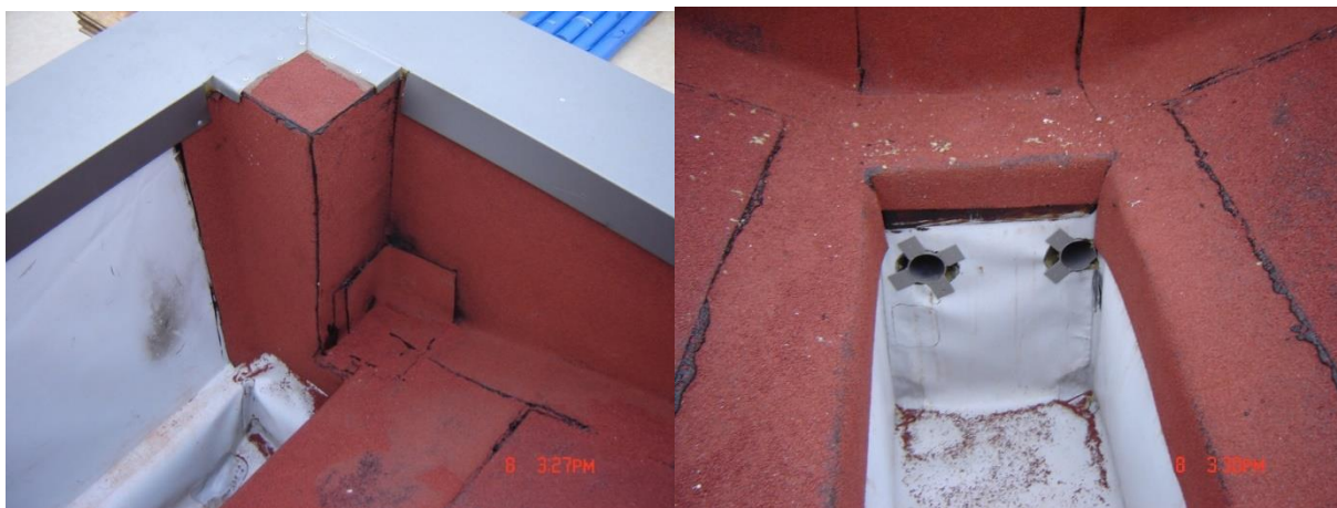
Obr. č. 175 - Kombinace asfaltových hydroizolací s fóliemi nejsou bohužel ojedinělé
