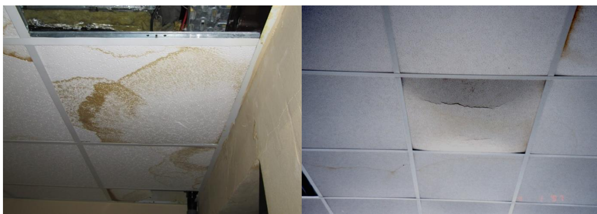
Obr. č. 16 – Dramaticky poničený sádkartonový podhled – šablony nasáknou vodou a pak radostně padají
