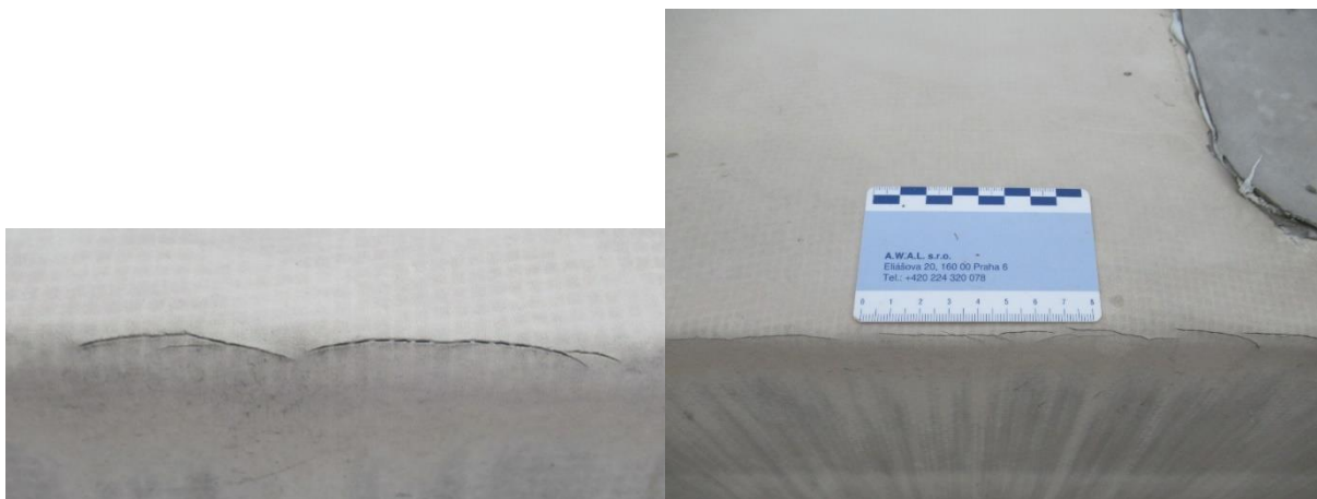
Obr. č. 108 – Ohybová trhlinka fóliové izolace, jejíž životnost již skončila
