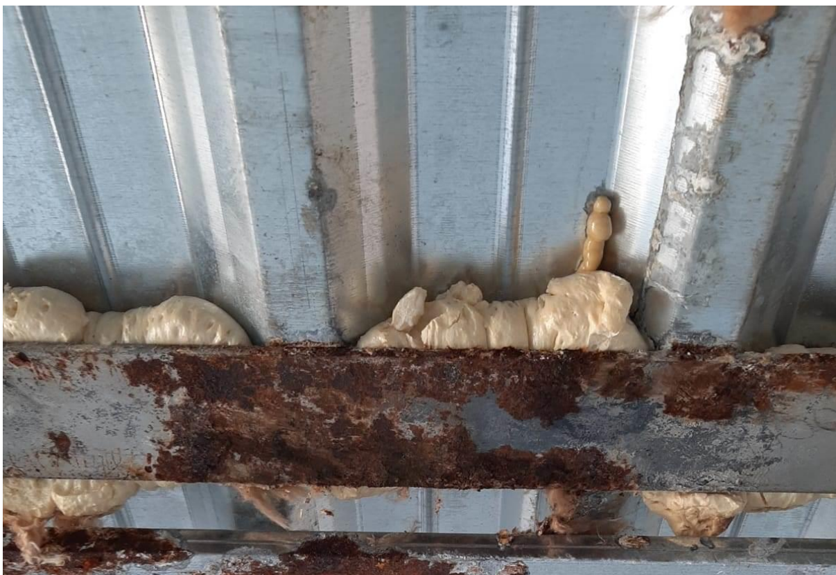
Obr. č. 18 – Nosná konstrukce z kovových prvků se stopami dlouhodobého zatékání
