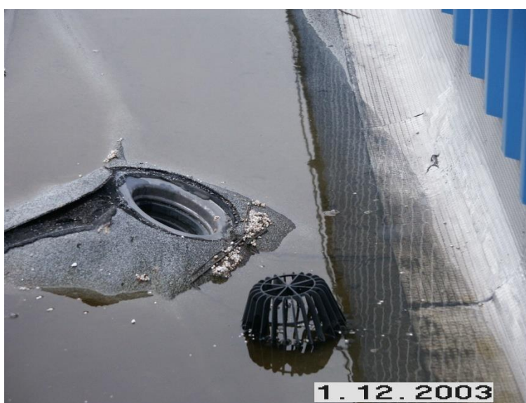
Obr. č. 245 – Nedostatečně mechanicky přikotvená vpust, která byla vytržena působením větru
