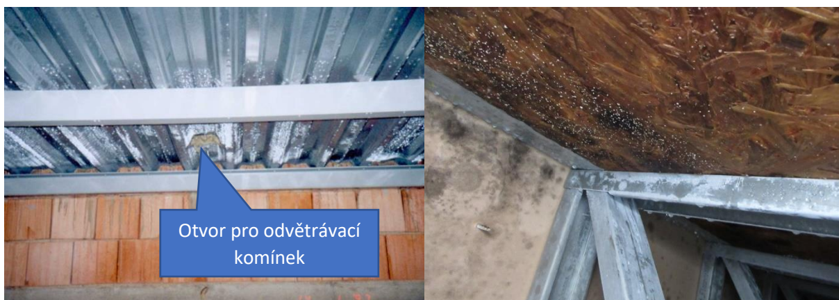
Obr. č. 25 – Kondenzace na chladném povrchu plechové krytiny. Největší množství kondenzátu je v oblasti odvětrávacího komínku
