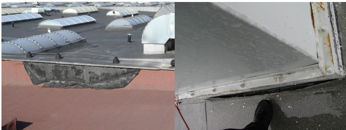
Obr. č. 217 – Hydroizolační povlak upadlý z mezilehlé atiky
