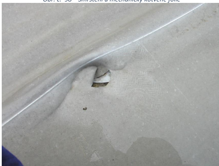
Obr. č. 99 – Smrštění fólie s mechanickým kotvením - fólie kolem kotvení je přetržená
