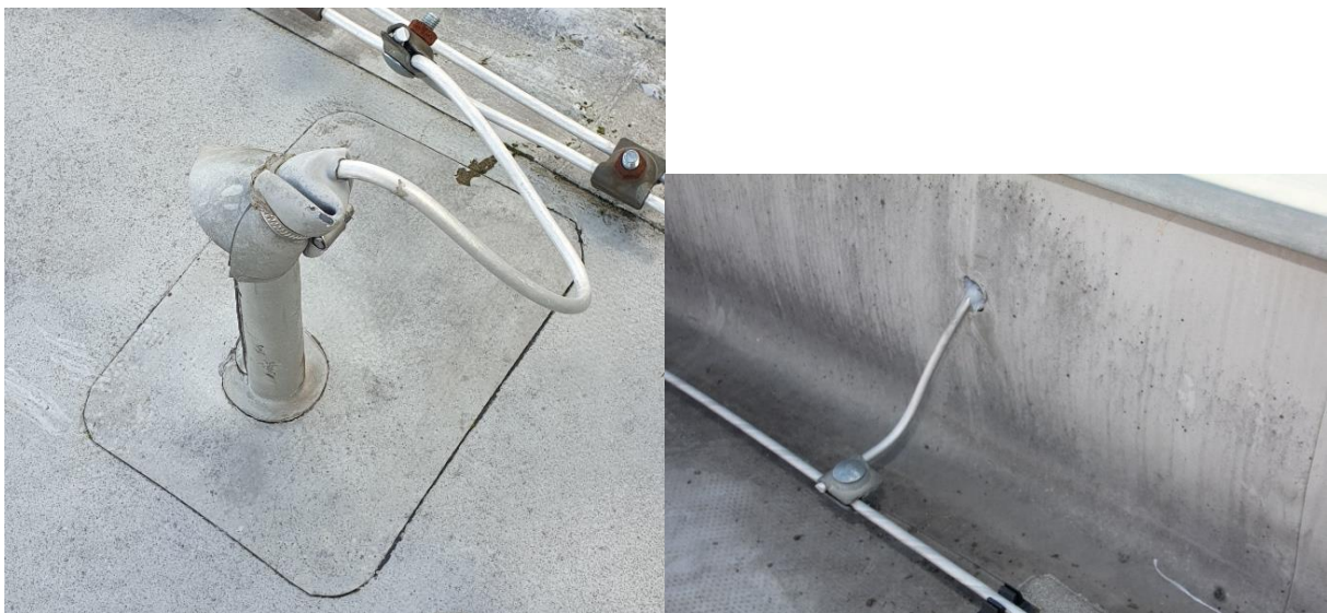
Obr. č. 156 – Kabelový vstup, vstup pro hromosvod
