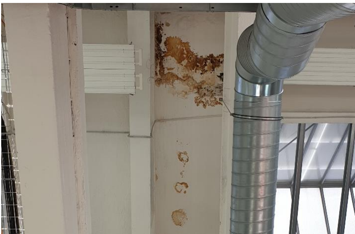
Obr. č. 20 – Masivní zatékání střešním pláštěm již se stopami výluhů z výztuže nosné konstrukce
