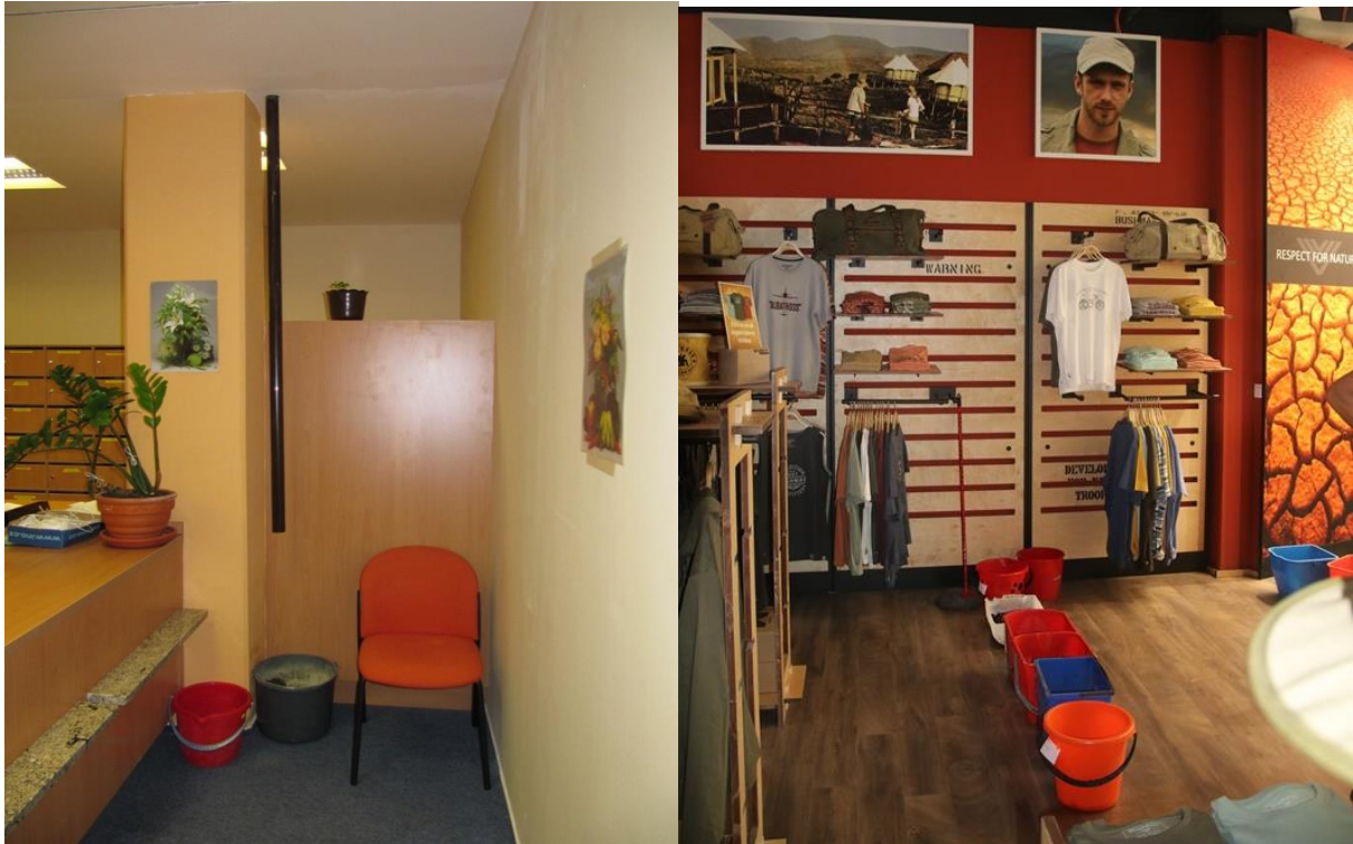
Obr. č. 34 – Sofistikované svádění zatékající vody do kyblíku i s náhradním, který je vždy připraven
