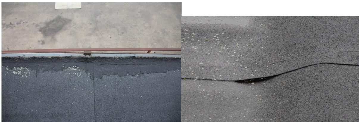
Obr. č. 195 – Utržení, resp. oprava hydroizolačního povlaku utrženého od závětrné lišty
