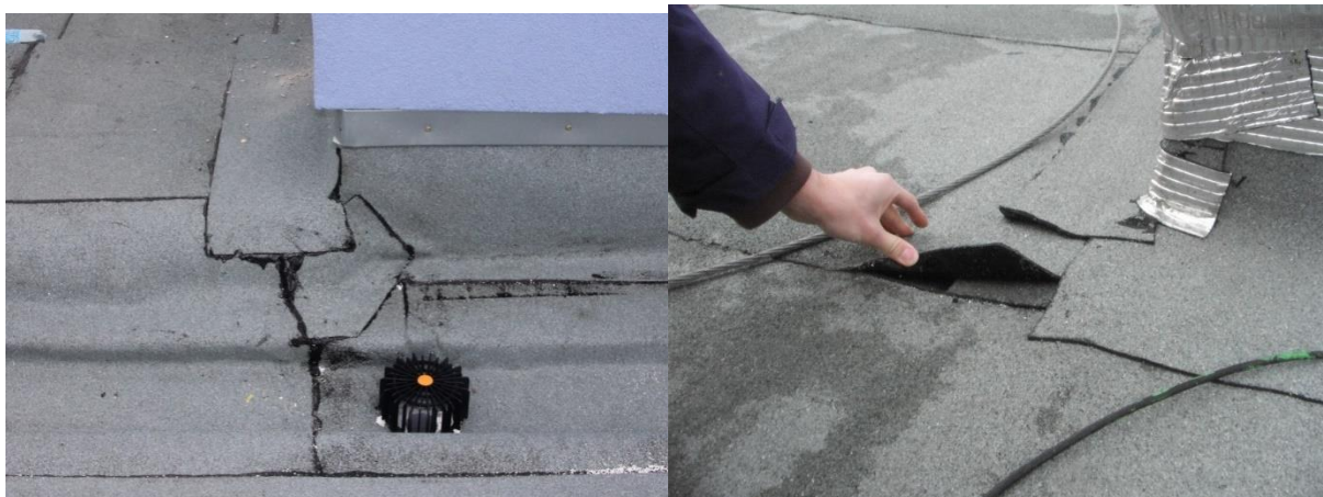
Obr. č. 220 – Neodborné nařezání hydroizolačního povlaku při tvarových změnách podkladu
