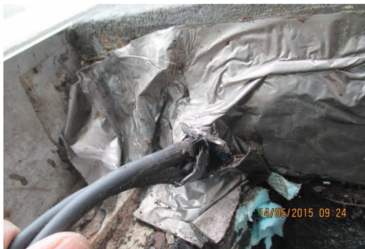
Obr. č. 240 – Kabelový vstup olepený asfaltovými samolepkami
