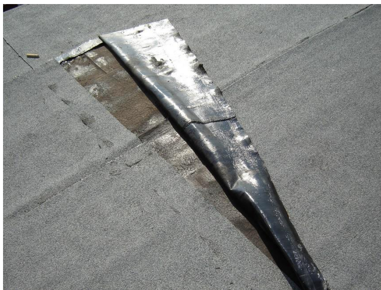
Obr. 142 – Naprosto nekorektně spojený příčný přesah asfaltových pásů
