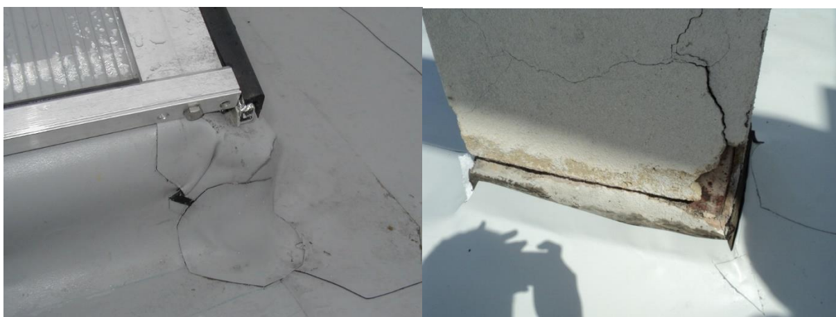
Obr. č. 140 – Chybné provedení opravování povlaku na rohu konstrukce
