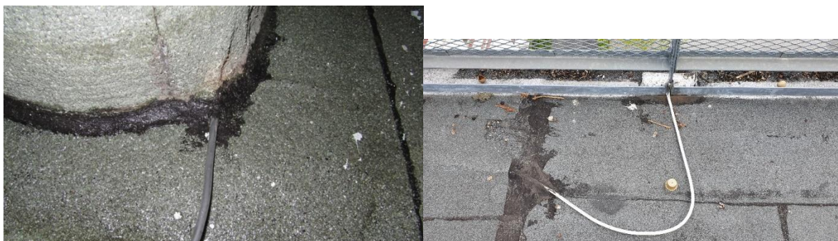
Obr. č. 235 – Brutální řešení - přímý vstup drátu skrz hydroizolaci
