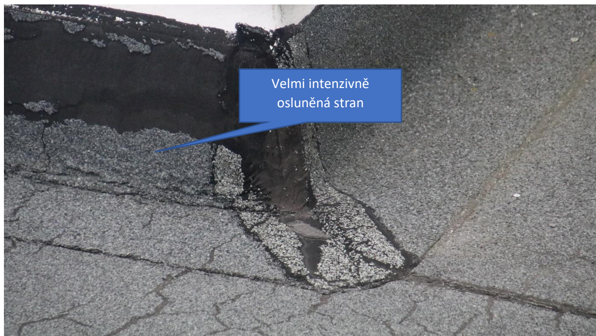
Obr. č. 79 – Stékání asfaltové hydroizolace ze svislých konstrukcí v kombinaci s krokodýlingem
