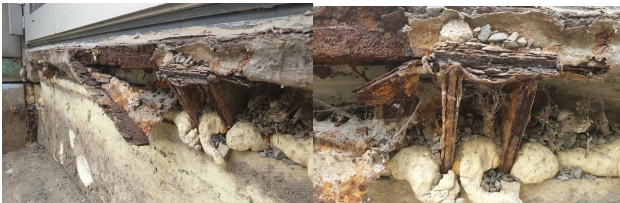
Obr. č. 48 – Koroze nosníku dveří
