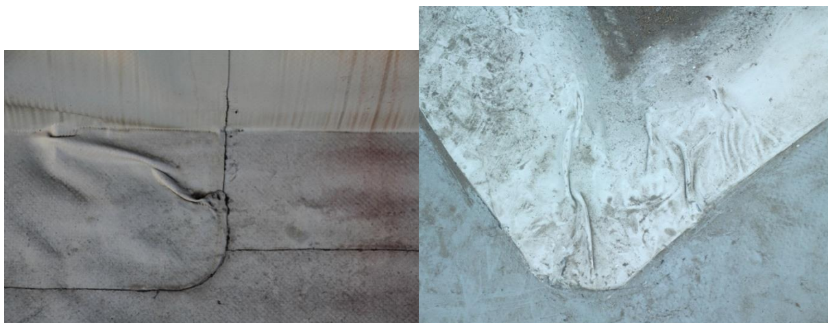
Obr. č. 118 – Detail provedení hydroizolačního povlaku s vrásami, které jsou příčinou následných netěsností
