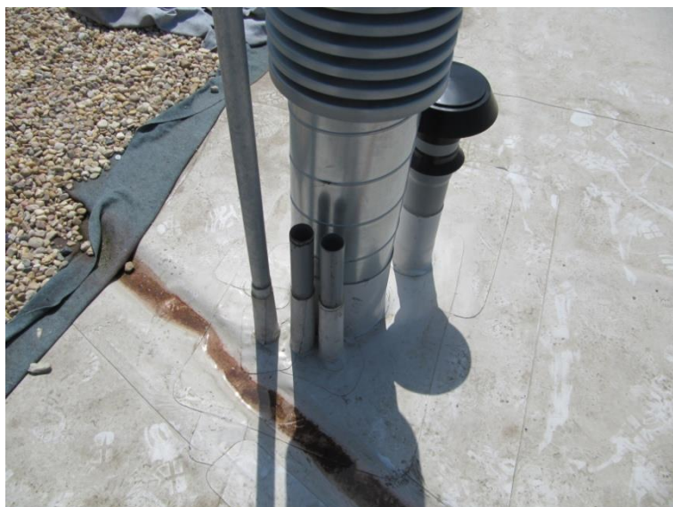
Obr. č. 160 – Kolem tohoto seskupení prostupů je hydroizolační povlak korektně neproveditelný
