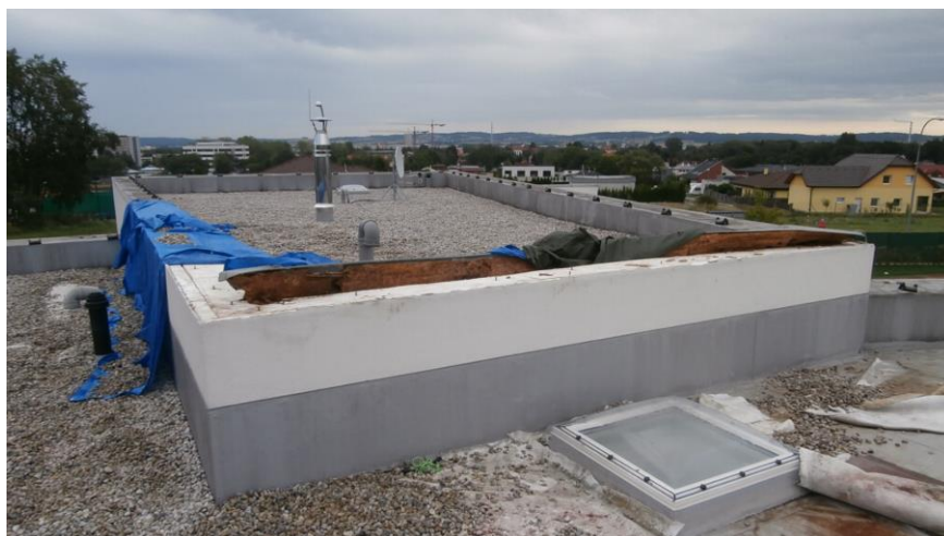
Obr. 1 - Větrek poškozená atika
