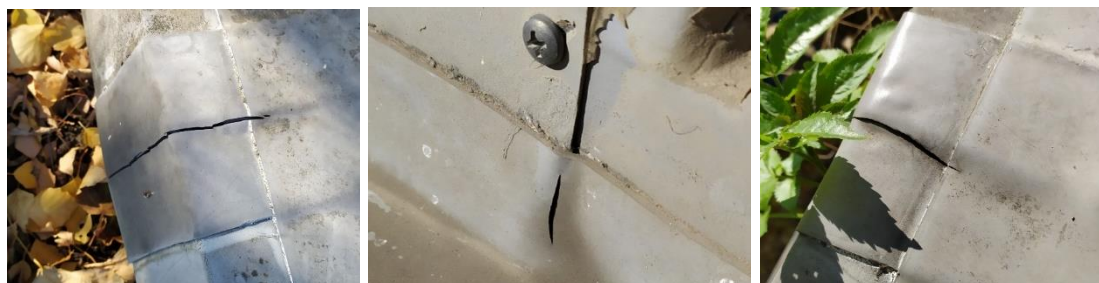
Obr. 4: Chybně provedené dilatační spoje – praskání fólie
