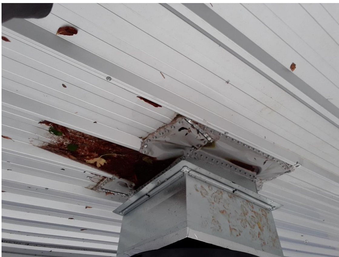
Kotvení manžety (realizátor odmítl uznat reklamaci)
