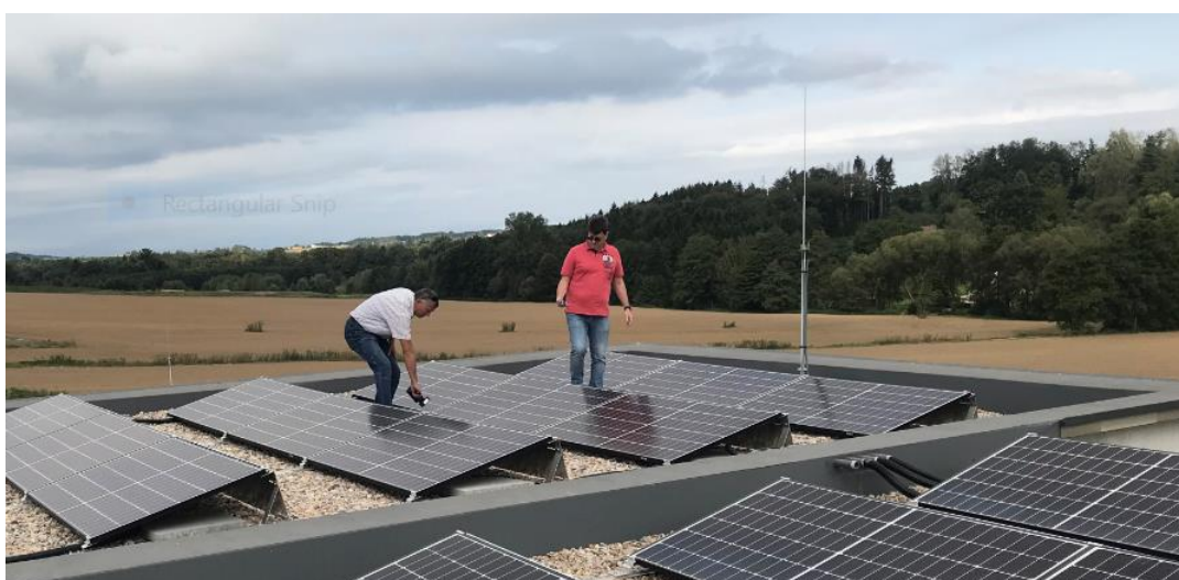
5) Následná měření senzorů může komplikovat fotovoltaika (je třeba se pod ní ohnout ☺)
