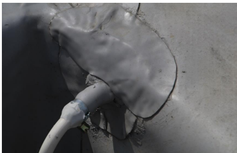
Obr. 2 – Opět špatné opracování prostupu s pomocí většího množství detailové folie
